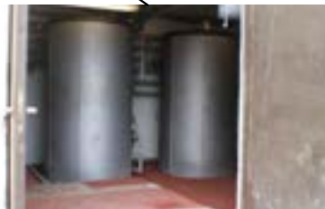
Serbatoi di accumulo termico
