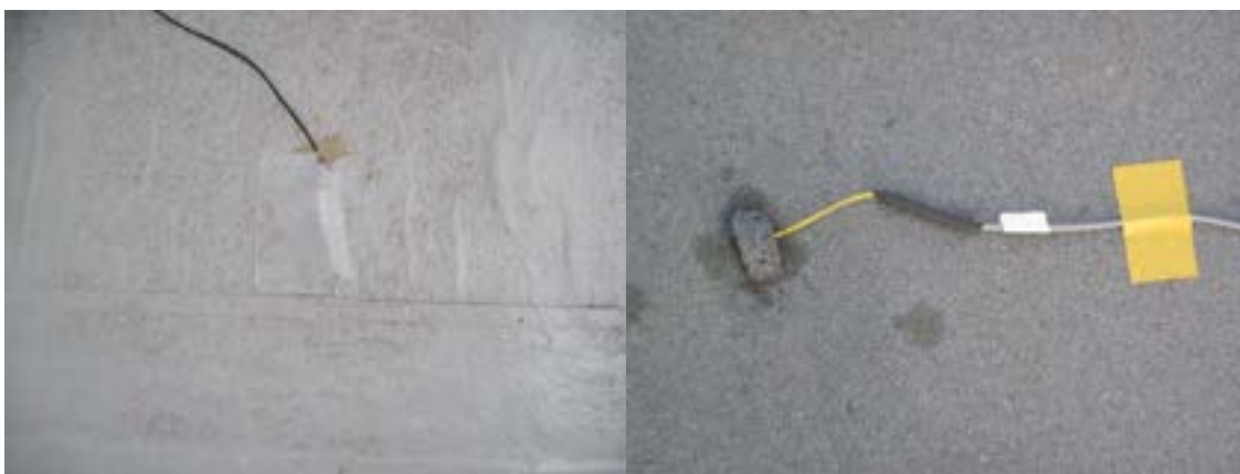
Figura 9: Termo - Resistenze montate sulla copertura
