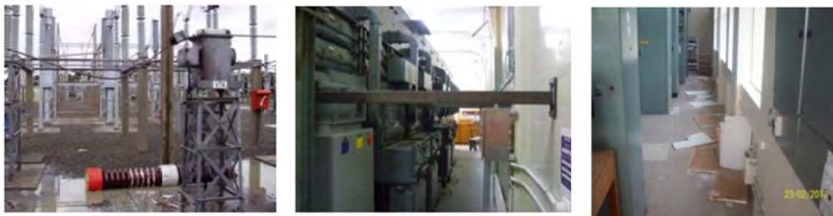
Figura 18. Sottostazione di Bromley: a) trasformatore di tensione corrente a 220 kV, caduta b) Controventatura Bromley installata nella parte anteriore e posteriore dei pannelli del quadro elettrico; c) pannelli del controsoffitto dislocati nell'edificio di controllo e relè, (Foto gentilmente fornite da Transpower).
