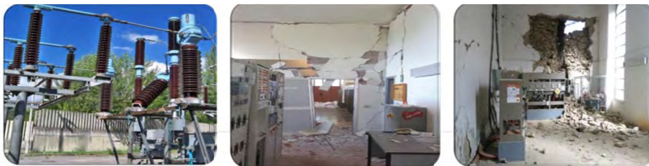
Figura 5. Danni alla sezione alta tensione, AT indotti dal terremoto di Amatrice (Italia Centrale) del 24/08/2016: a) caduta dei sezionatori AT; b),c) danni al fabbricato della cabina primaria, e quadro di media tensione intatto (fotografie estratte da [4]).
