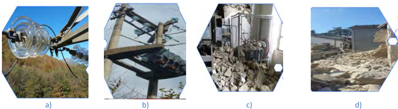
Figura 7. Danni alle linee MT e BT: a) sostegni sbandati e conduttori a terra; b) posti di trasformazione su palo PTP caduti dalle mensole; c) danni ai fabbricati delle cabine secondarie in muratura; d) linee aeree BT danneggiate dal collasso di edifici prospicienti (fotografie estratte da [4]).
