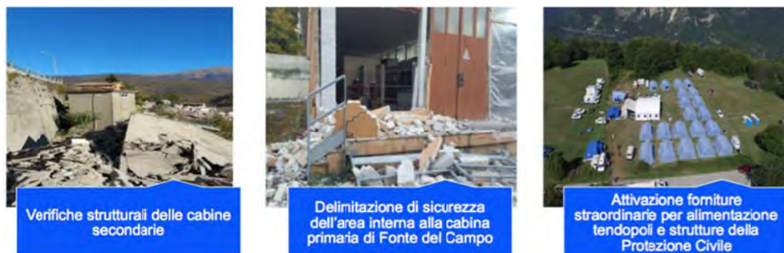
Figura 9. Operazioni nei primi giorni successivi all'evento: a) verifica strutturale delle cabine secondarie; b) delimitazioni di sicurezza nella cabina primaria di Fonte del Campo; c) attivazione fornitura elettrica per le tendopoli.
