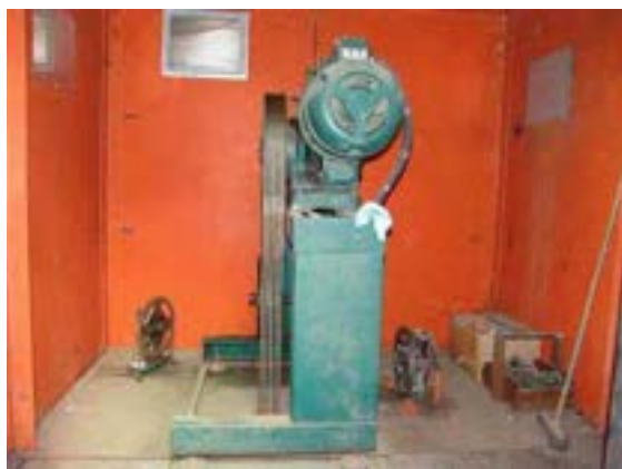
Fig. 5b – Locale motore, interno
