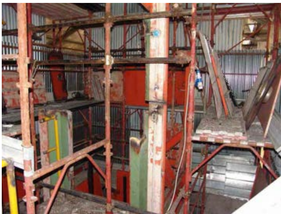
Fig. 13 – 14/6/10 vano ascensore al 7° piano della struttura con lamiera asportata
