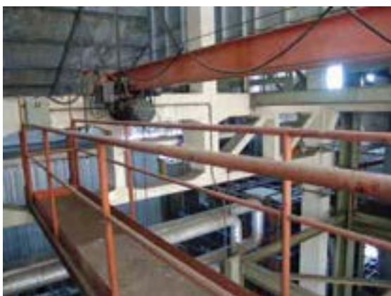
Fig. 21 – Gru a ponte
