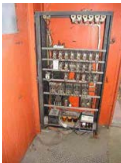
Fig. 5c – Locale motore, interno
