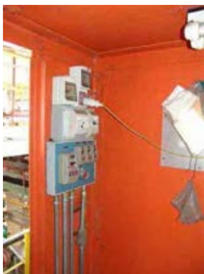
Fig. 5d – Locale motore, interno
