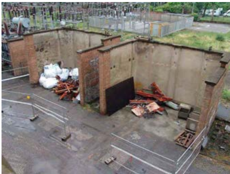
Fig. 18 – 15/6/10, deposito esterno con big bags e materiali ferrosi depositati
