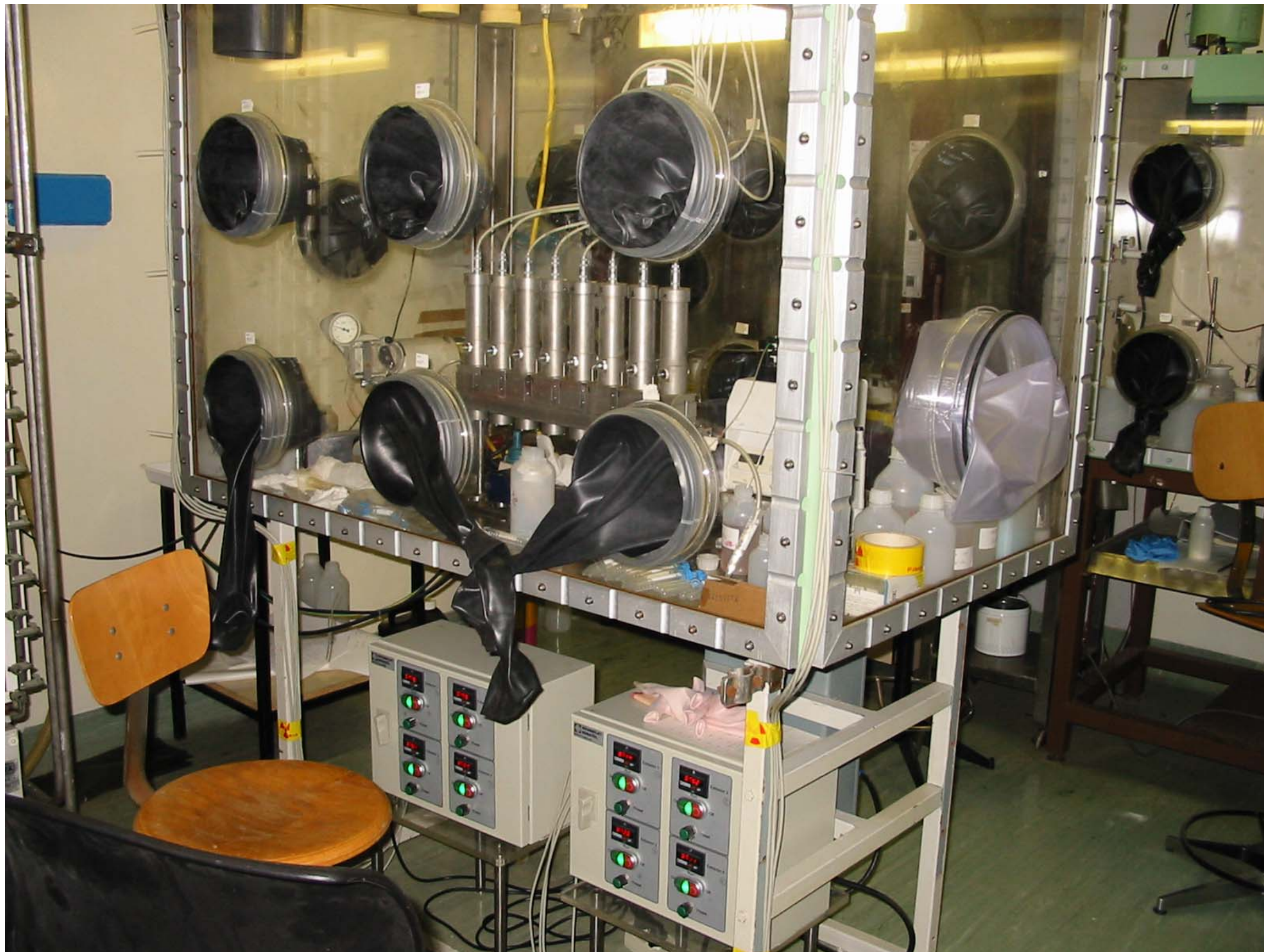
Fig.6 – Scatola a Guanti con impianto di estrazione controcorrente di attinidi da lantanidi tramite “estrattori centrifughi”
