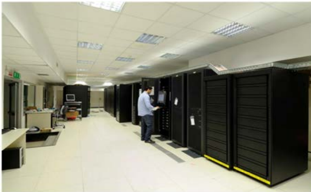
Figura 4 – Sala macchine Infrastruttura supercalcolatore CRESCO
