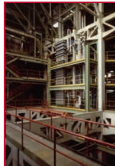
Impianto sperimentale SPES-2: vista laterale Nord zona sistemi sicurezza passivi (altezza totale impianto: 30 m)
