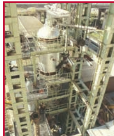
Vessel Impianto GEST (volume: 45 m 3 , altezza: 15 m)
