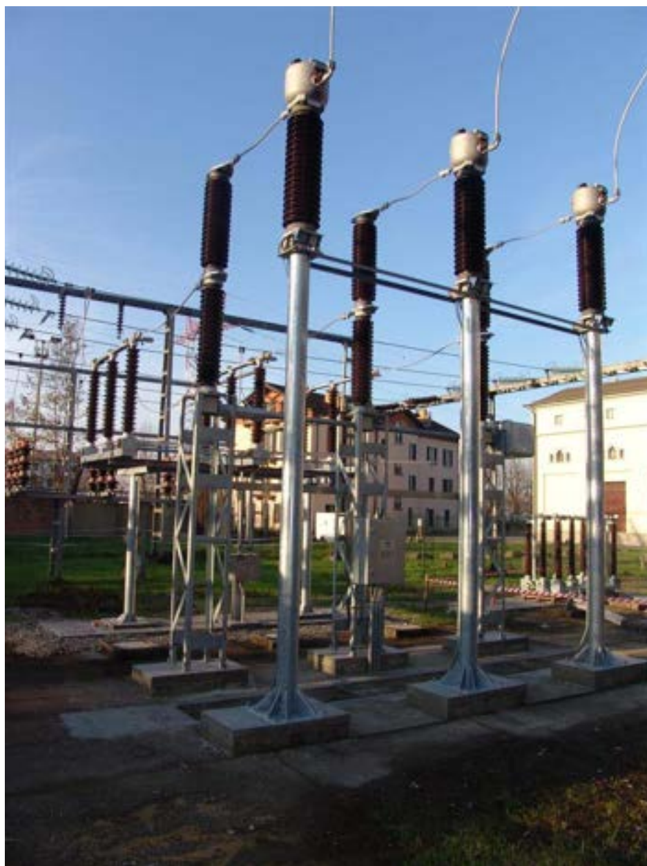
Figura n. 35 - Nuovi Interruttori e Sezionatori 130 kV
