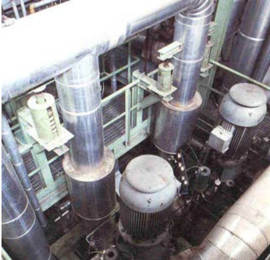
Figura n. 16 - Impianto GEST-GEN: Pompe Primarie
