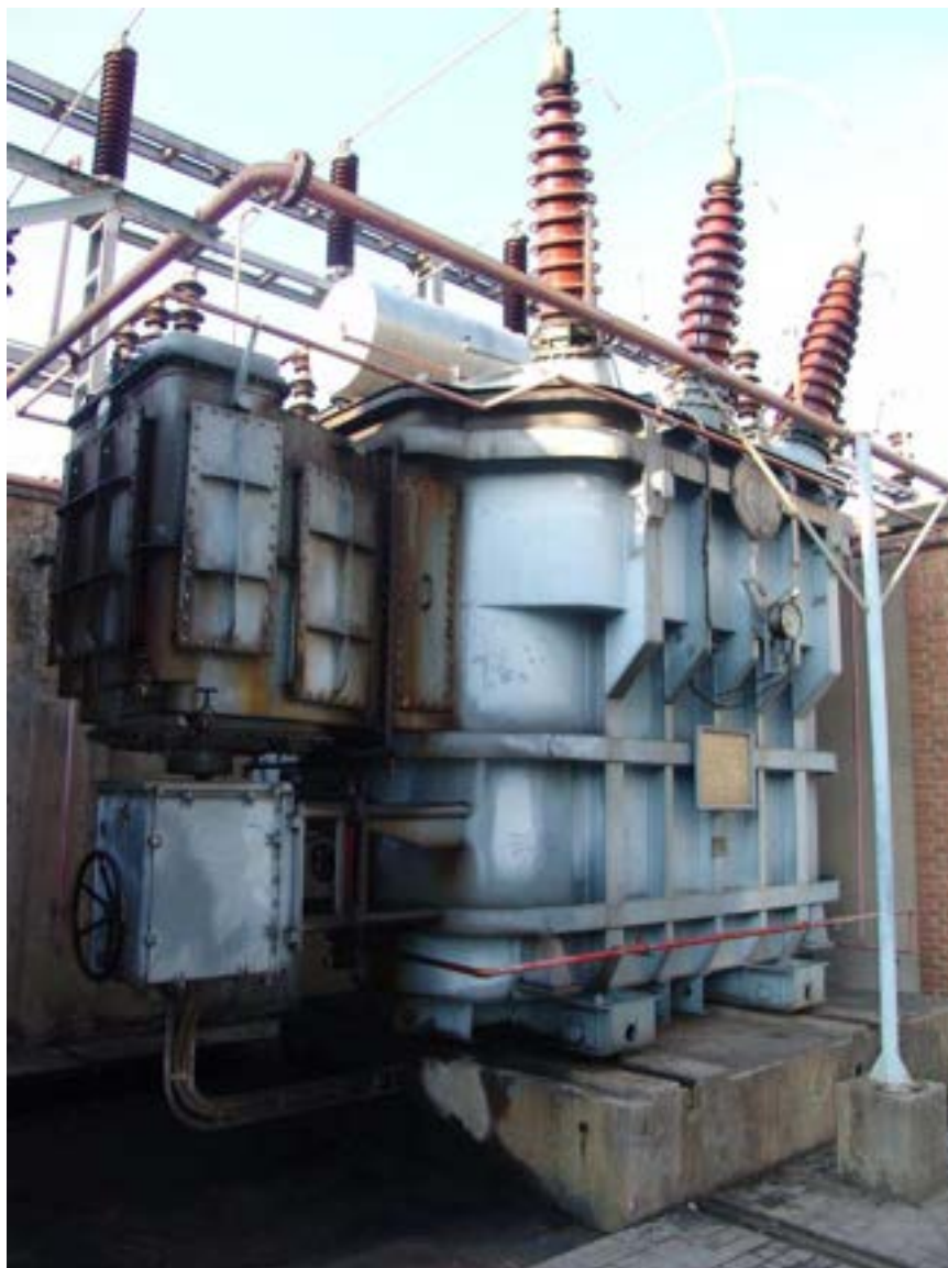
Figura n. 33 - Trasformatore 130 / 3 kV (CEM-2)
