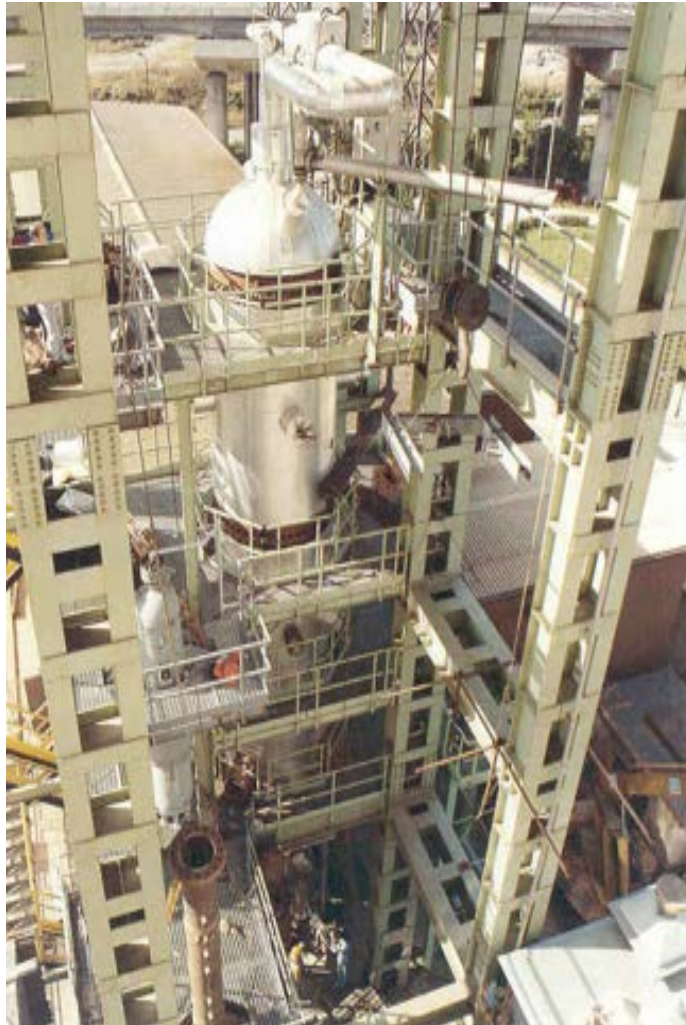
Figura n. 19 - Vessel Impianto GEST-SEP: vista dall'alto
