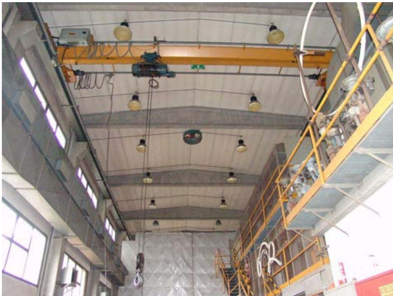
Figura n. 60 - Officina meccanica SIET – Carro-ponte da 5000 kg
