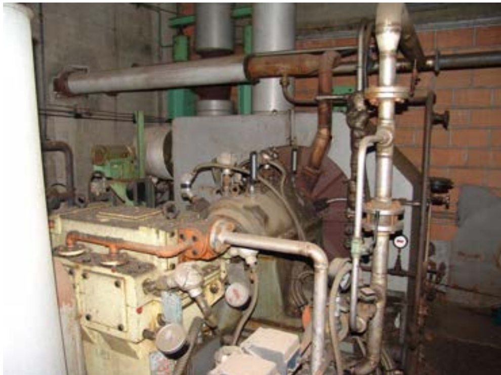
Figura n. 22 - Impianto GEST-SEP: compressore di vapore
