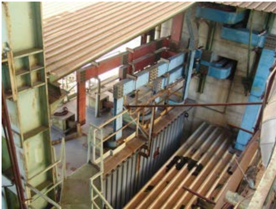
Figura n. 15 - Caldaia Elettrica Impianto GEST-GEN: vista dall'alto
