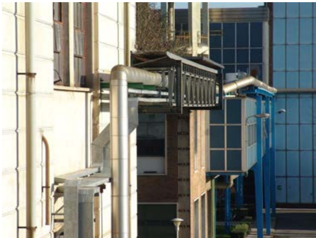
Figura n. 47 - Linea 5" Vapore Surriscaldato da Centrale Edipower
