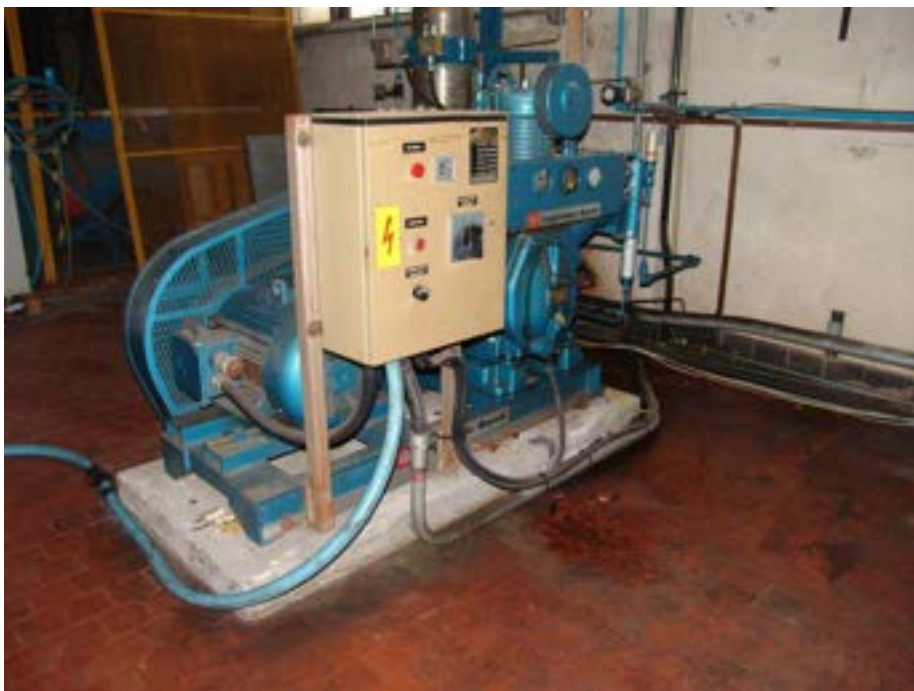
Figura n. 57 - Compressore aria servizi alta pressione (240 bar)
