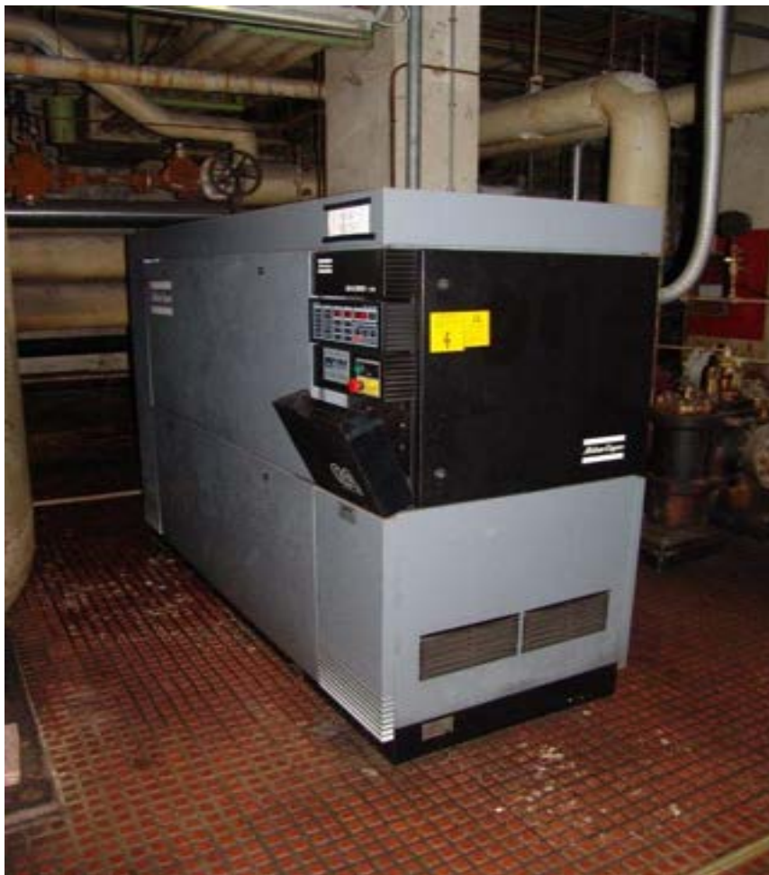
Figura n. 56 - Compressore aria servizi bassa pressione (7 bar)
