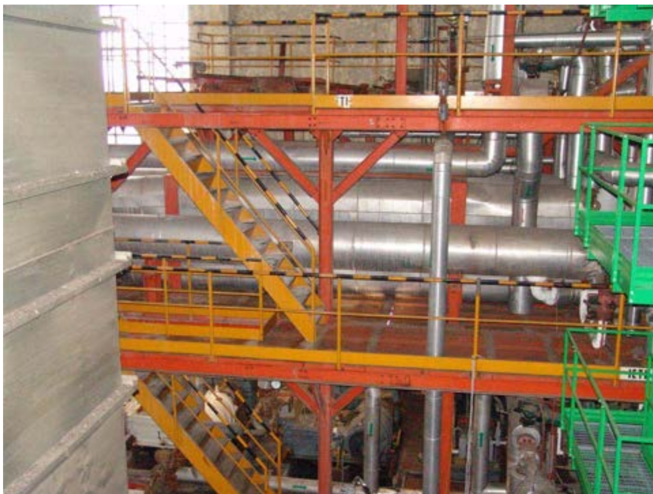
Figura n. 31 - Preriscaldatori Acqua impianto IETI-4
