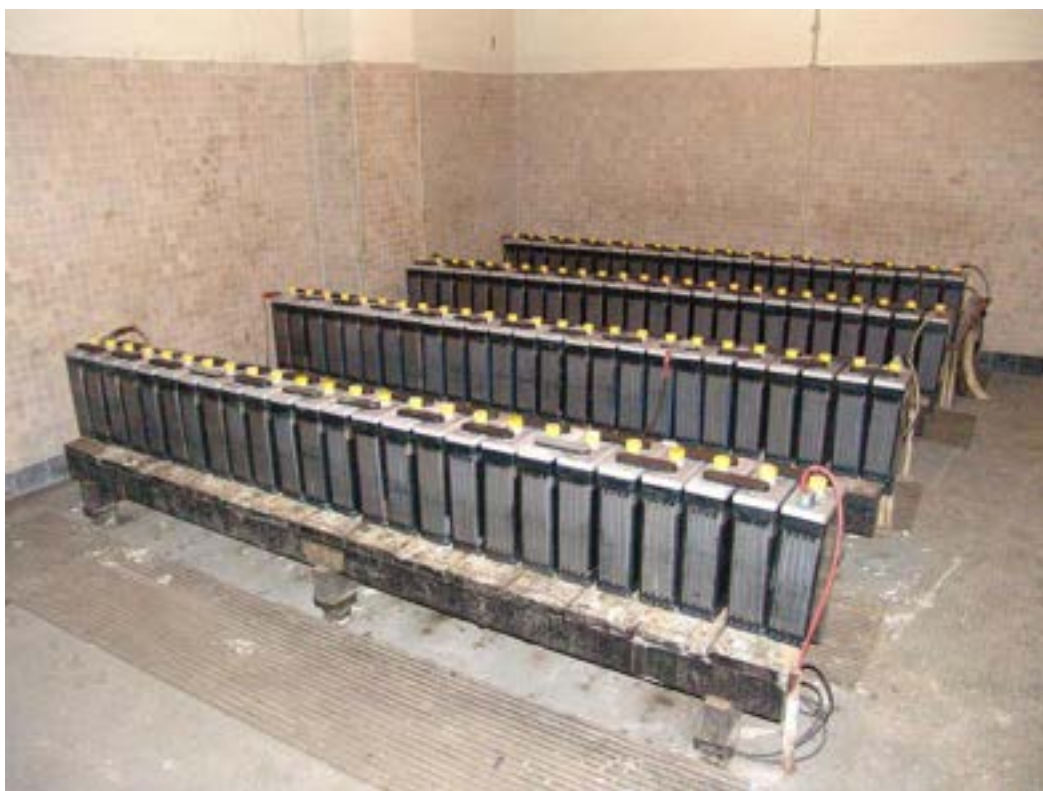
Figura n. 45 - Sala Batterie 220 V
