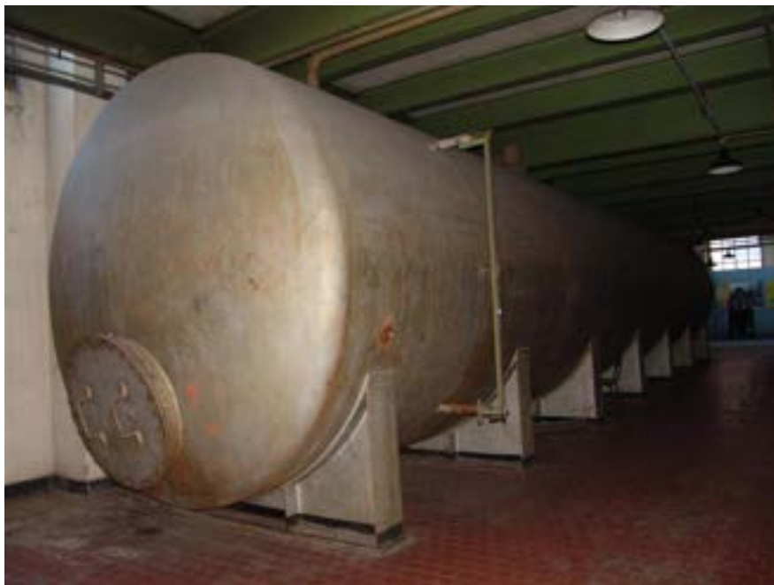
Figura n. 51 - Serbatoio Acqua Demineralizzata
