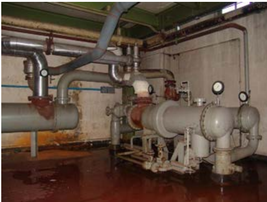
Figura n. 52 - Gruppo Condensazione Vapore
