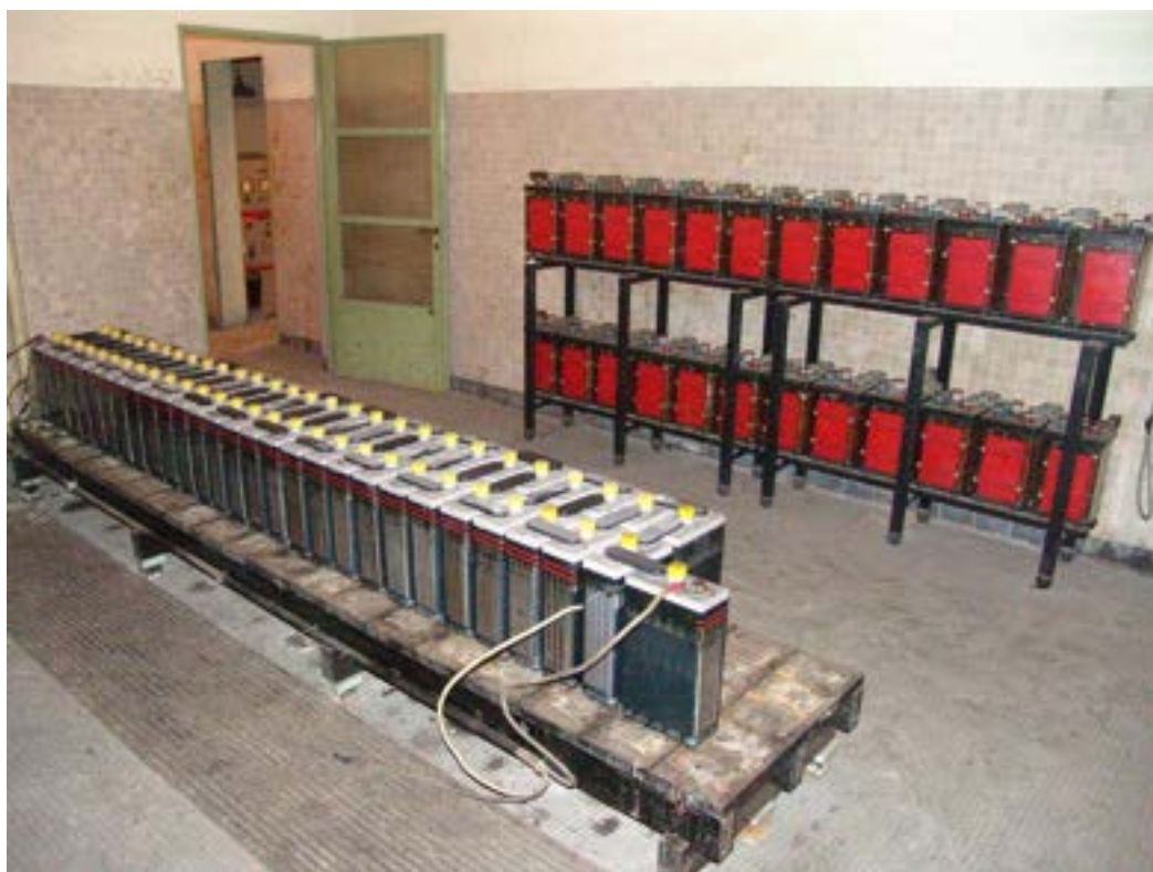
Figura n. 44 - Sala Batterie 110 V
