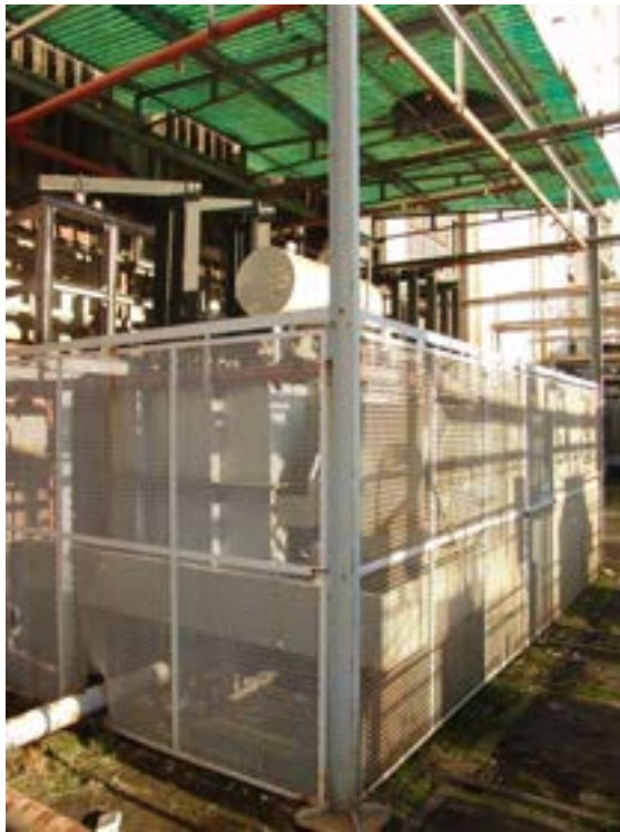
Figura n. 40 - Gruppo di potenza 4MW
