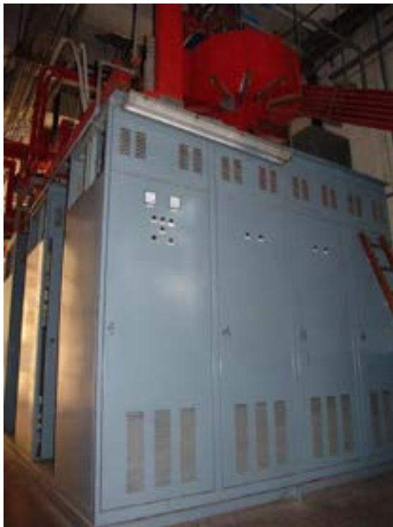
Figura n. 42 Armadio a Tiristori Gruppo di Potenza 4 MW
