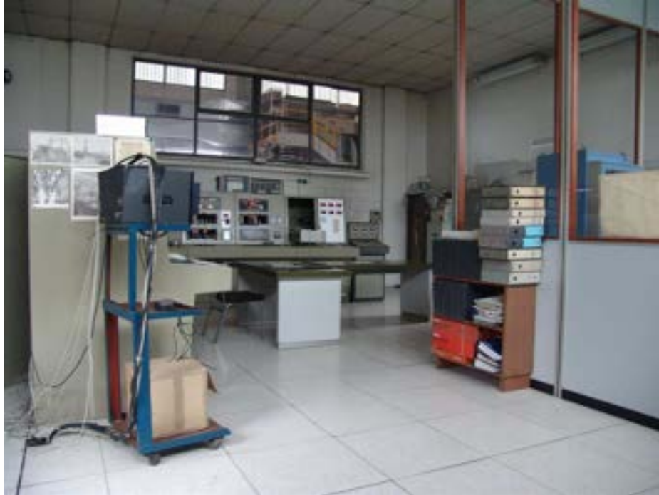
Figura n. 13 - Sala Manovra Impianto GEST
