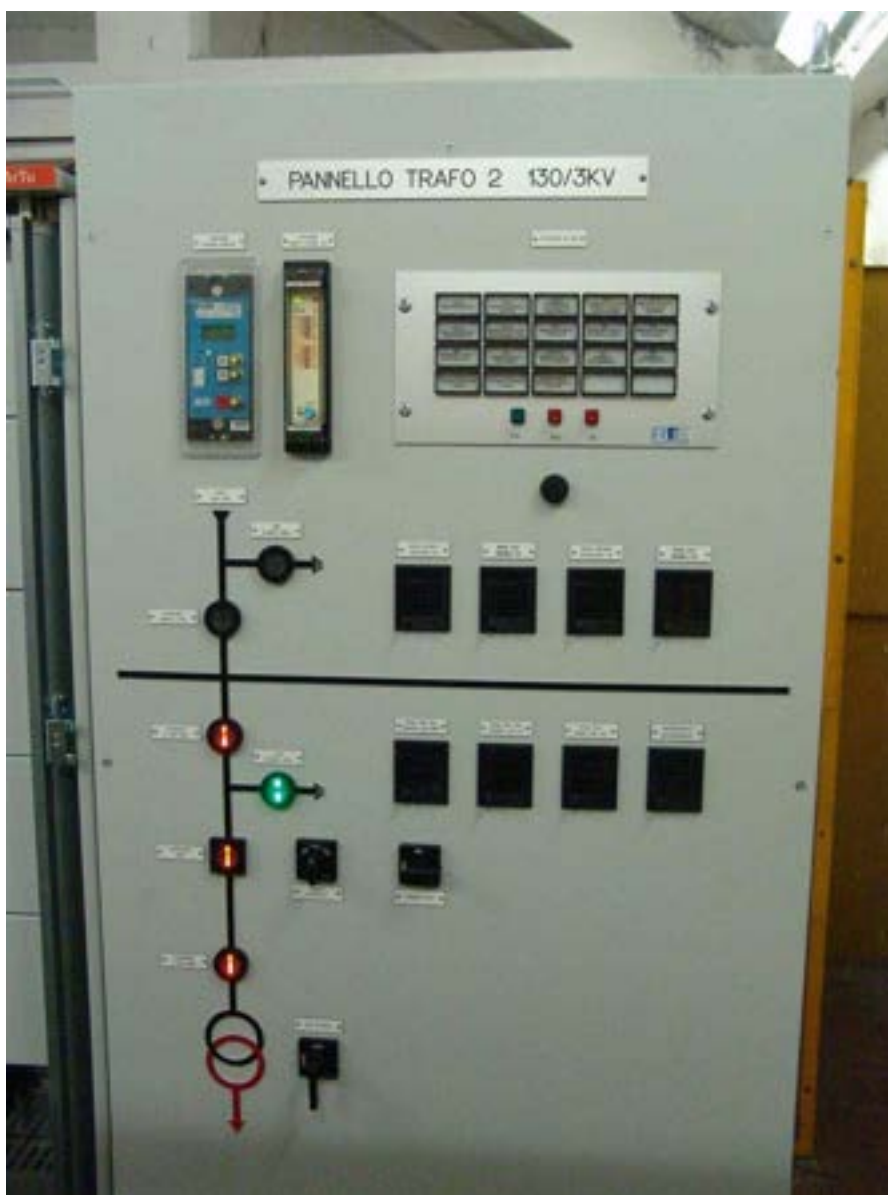
Figura n. 34 - Quadro comando interruttore AT
