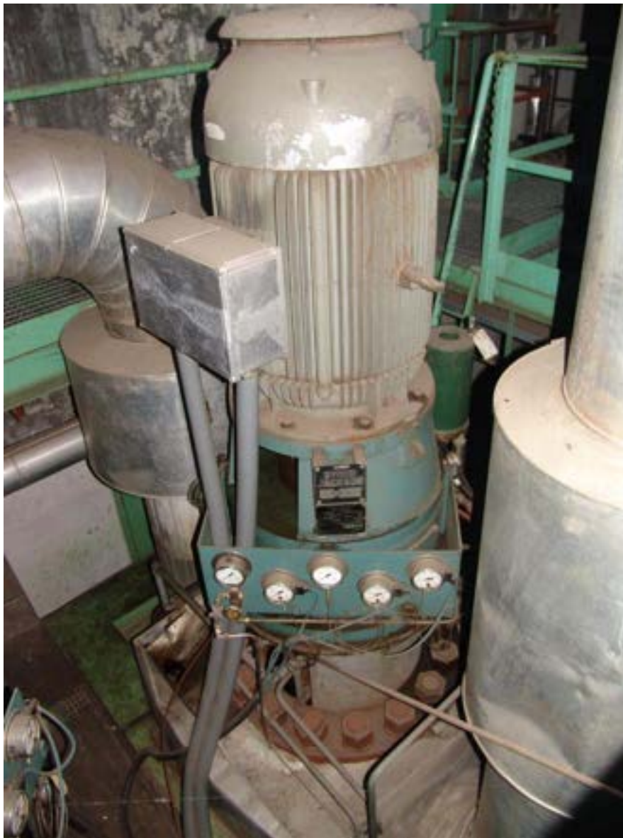
Figura n. 21 - Impianto GEST: Elettro-Pompa Primaria
