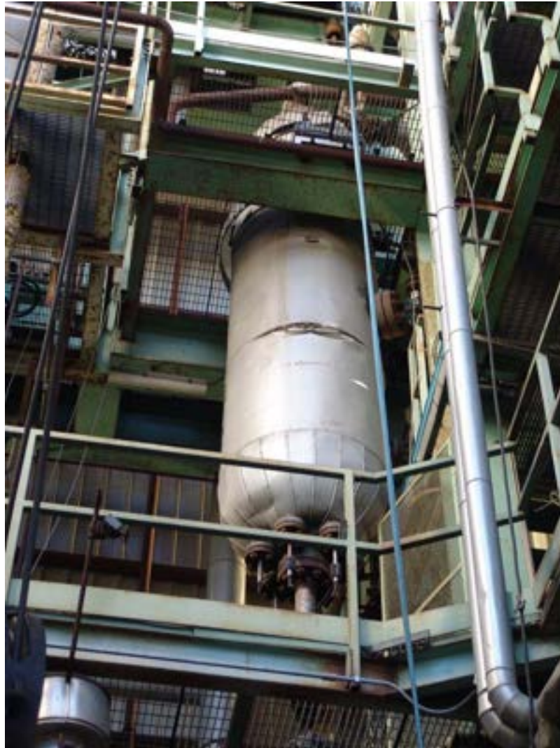
Figura n. 17 - Impianto GEST-GEN: Pressurizzatore Circuito Primario
