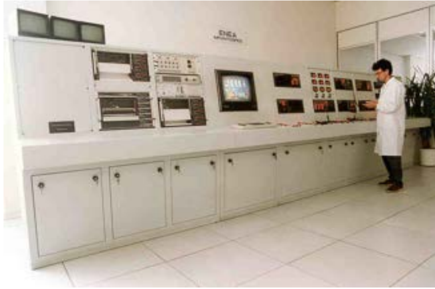
Figura n. 12 - Sala Controllo Impianto SPES
