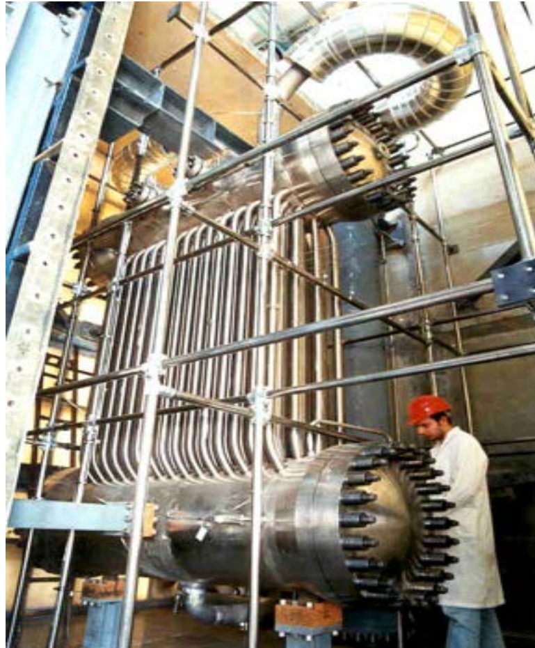
Figura n. 28 - Facility PANTHERS: Isolation Condenser
