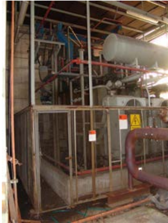
Figura n. 41 - Gruppo di potenza 8MW
