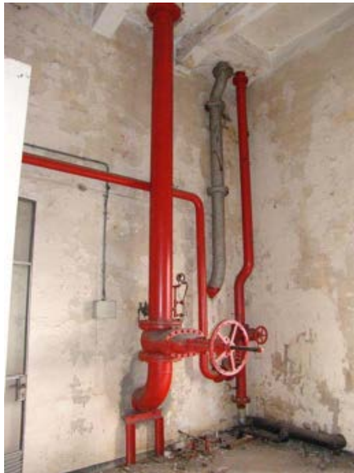
Figura n. 55 - Tubazioni antincendio sottostanti serbatoio pensile
