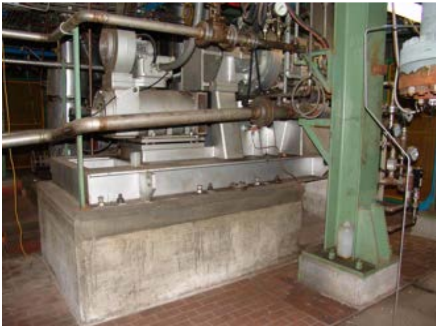
Figura n. 10 - Pompa Primaria Impianto SPES-2
