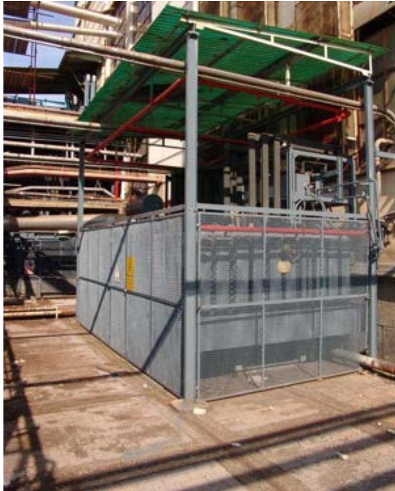
Figura 10 - Gruppo 4 MW dopo la manutenzione
