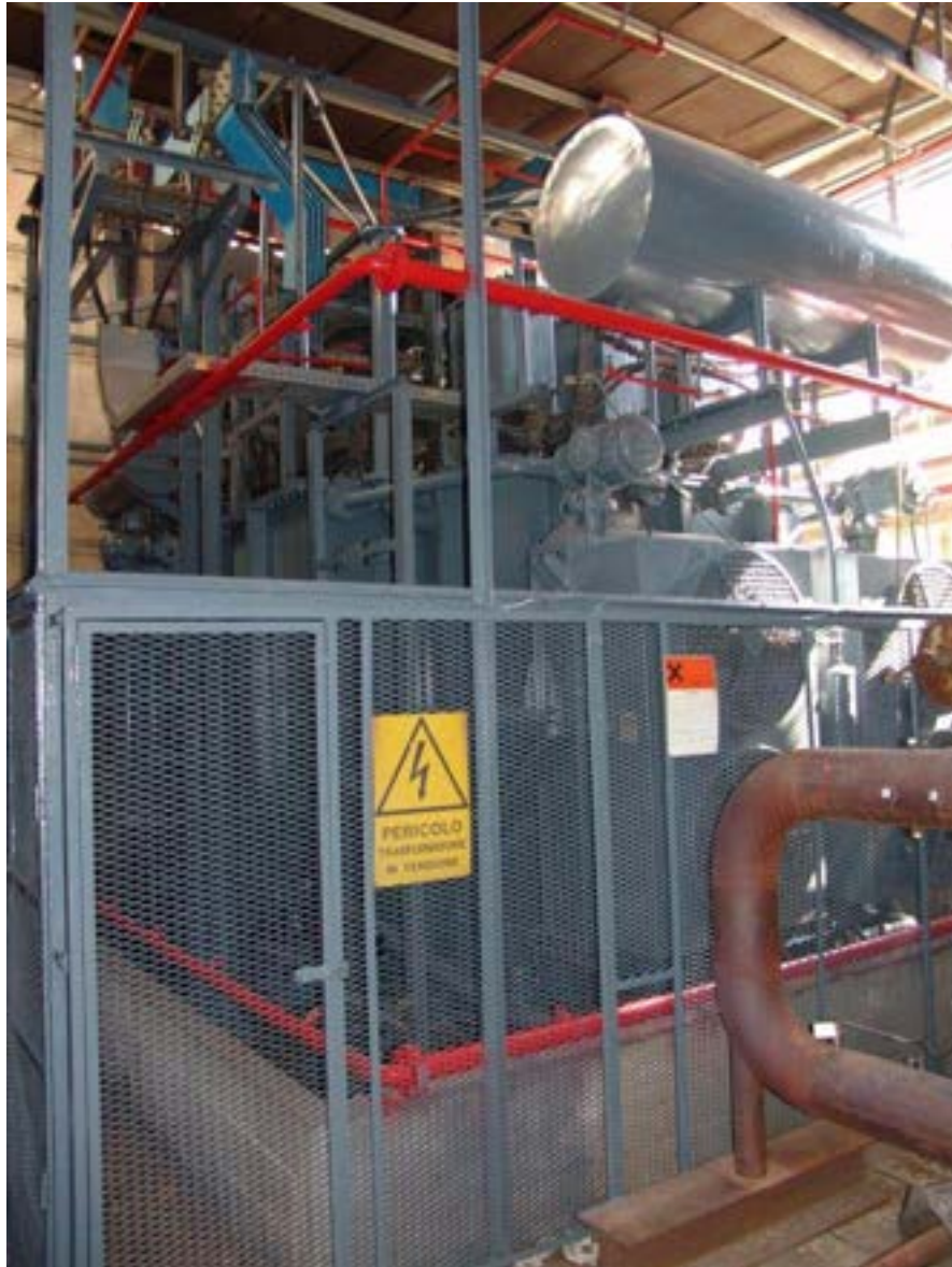
Figura 9 - Gruppo 8 MW dopo la manutenzione
