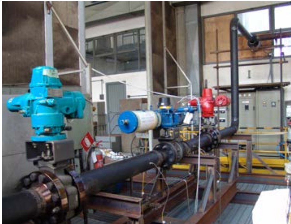
Figura 45 - PROVE DI FUNZIONALITA' IN VAPORE SU VALVOLE DI INTERCETTAZIONE A FARFALLA SU IMPIANTO GEST
