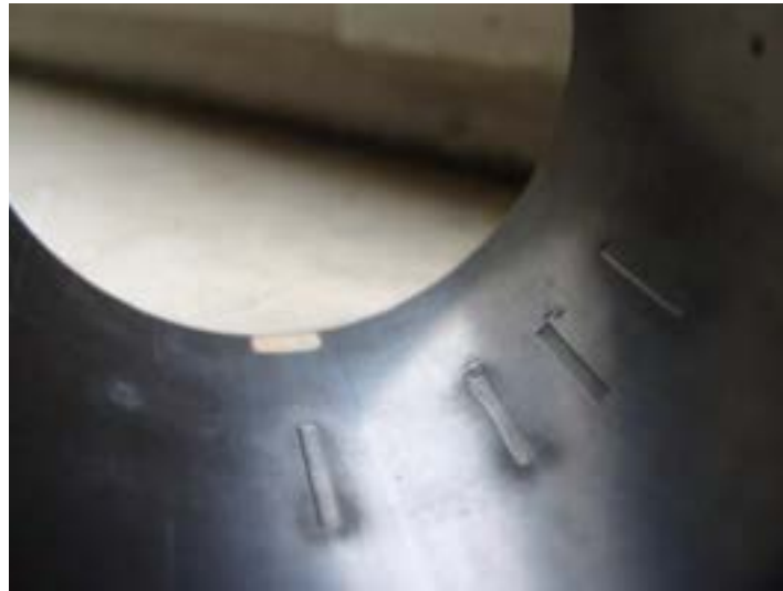
Figura 56 - TUBO IN PRESSIONE CANALE CIRENE CON SEGNI DI FRETTING CORROSION
