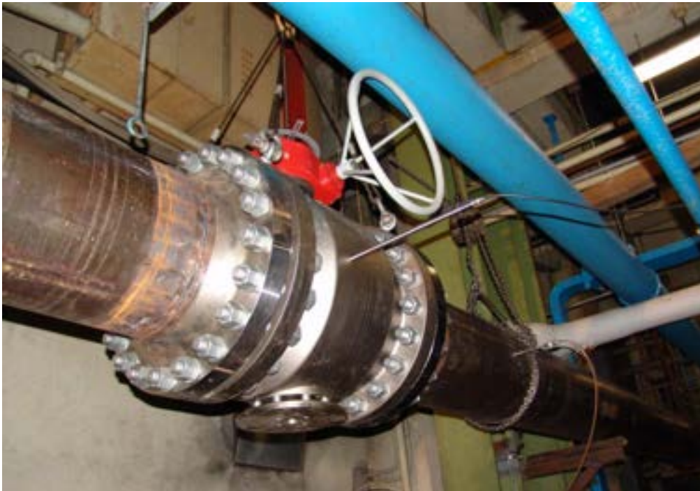
Figura 44 - PROVE DI CARATTERIZZAZIONE SU VALVOLA DI INTERCETTAZIONE A SFERA DA 16 " SU IMPIANTO VALFRE
