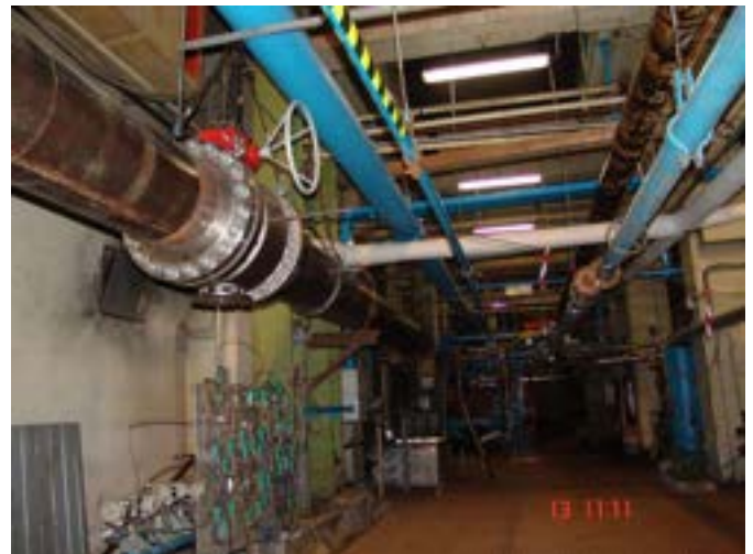
Figura 10 - IMPIANTO VALFRE: PIPING CON VALVOLA IN PROVA
