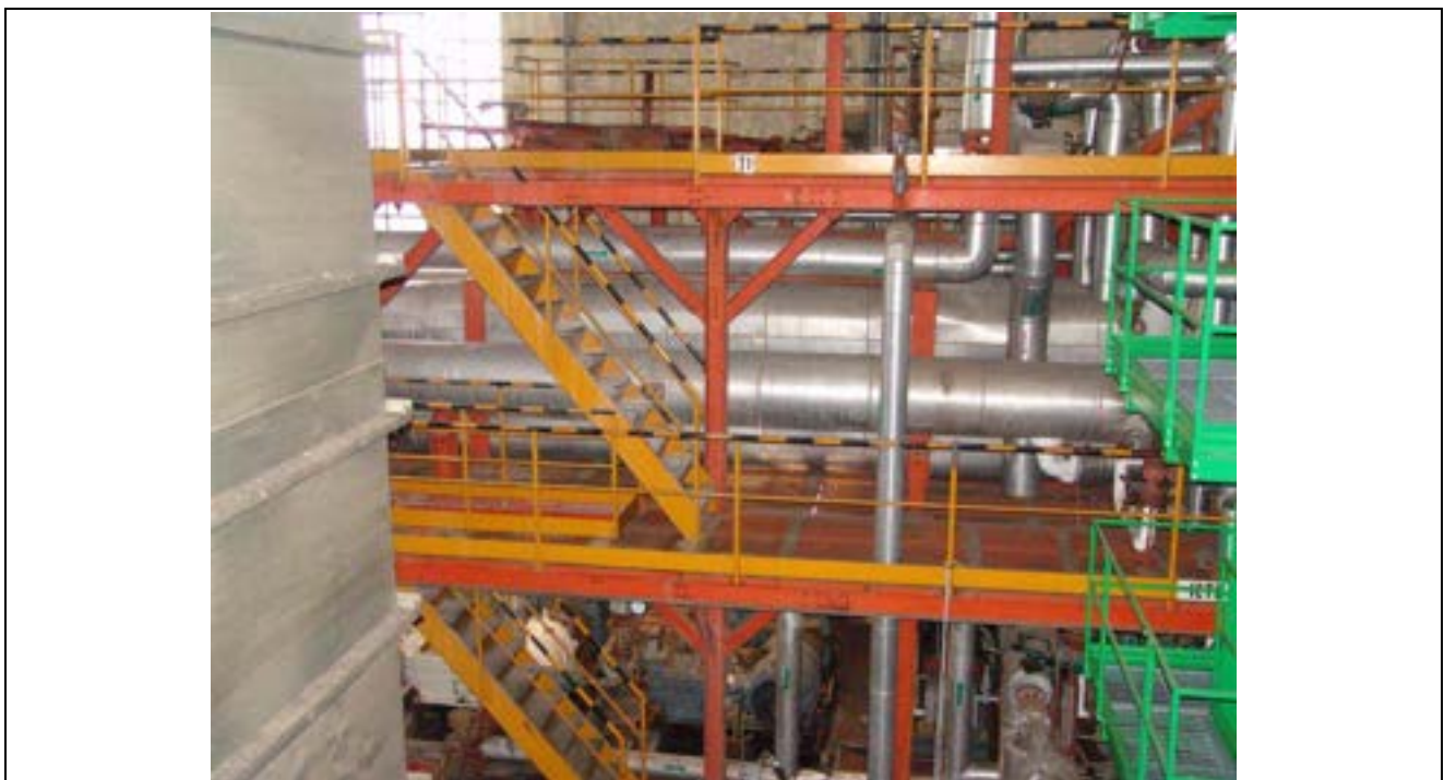
Figura 8 - PRERISCALDATORI ACQUA IMPIANTO IETI-4
