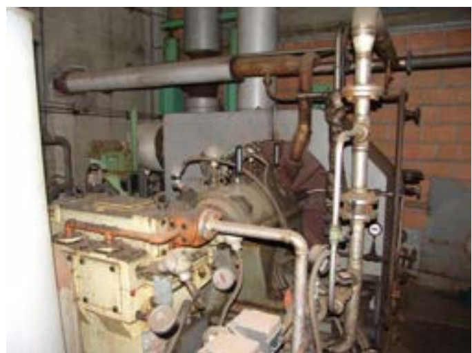
Figura 5 - COMPRESSORE DI VAPORE IMPIANTO GEST-SEP
