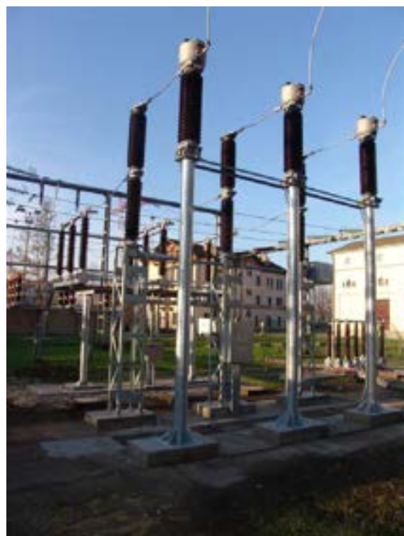
Figura 12 - NUOVI INTERRUTTORI E SEZIONATORI 130 KV
