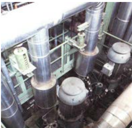
Figura 4 - POMPE PRIMARIE IMPIANTO GEST
