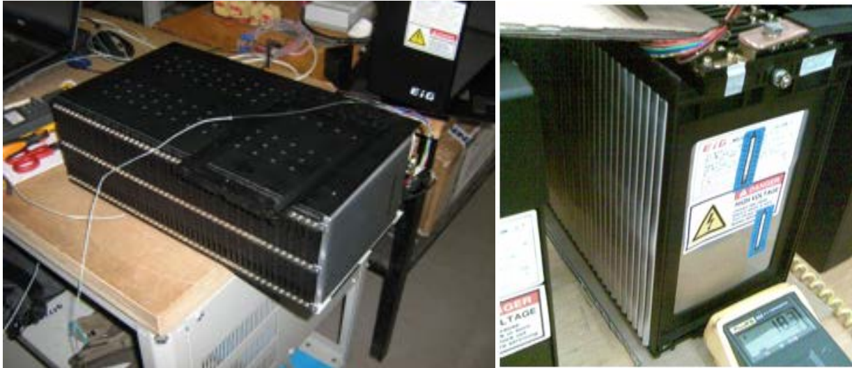
Fig 4 Il pacco batterie privo delle coperture laterali a) vista laterale b) i soli moduli
