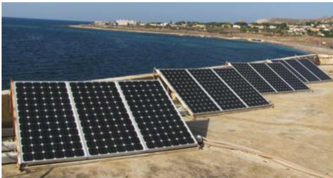
Fig. 4.9 - Campo FV in silicio policristallino utilizzato per la fase di test (campo 1).
