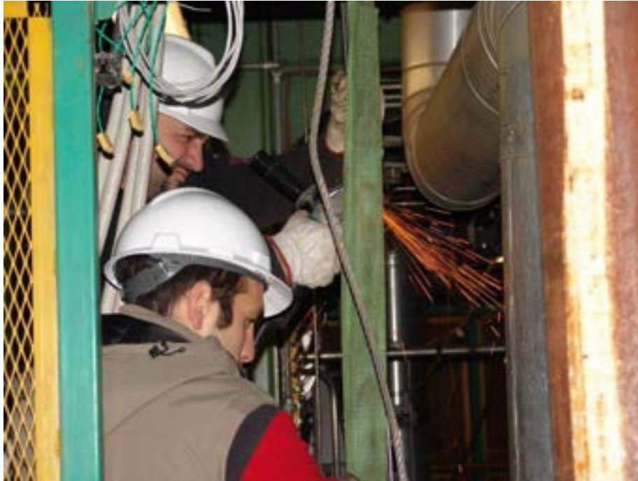
Fig. 6. 4 - Fasi di montaggio: lavori al piano 5° della Centrale Emilia per agevolare l'inserimento delle barre scaldanti
