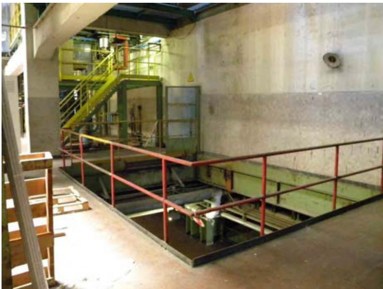
Foto n°3: Buca di attraversamento materiali al piano I° di Centrale (piano governo)
