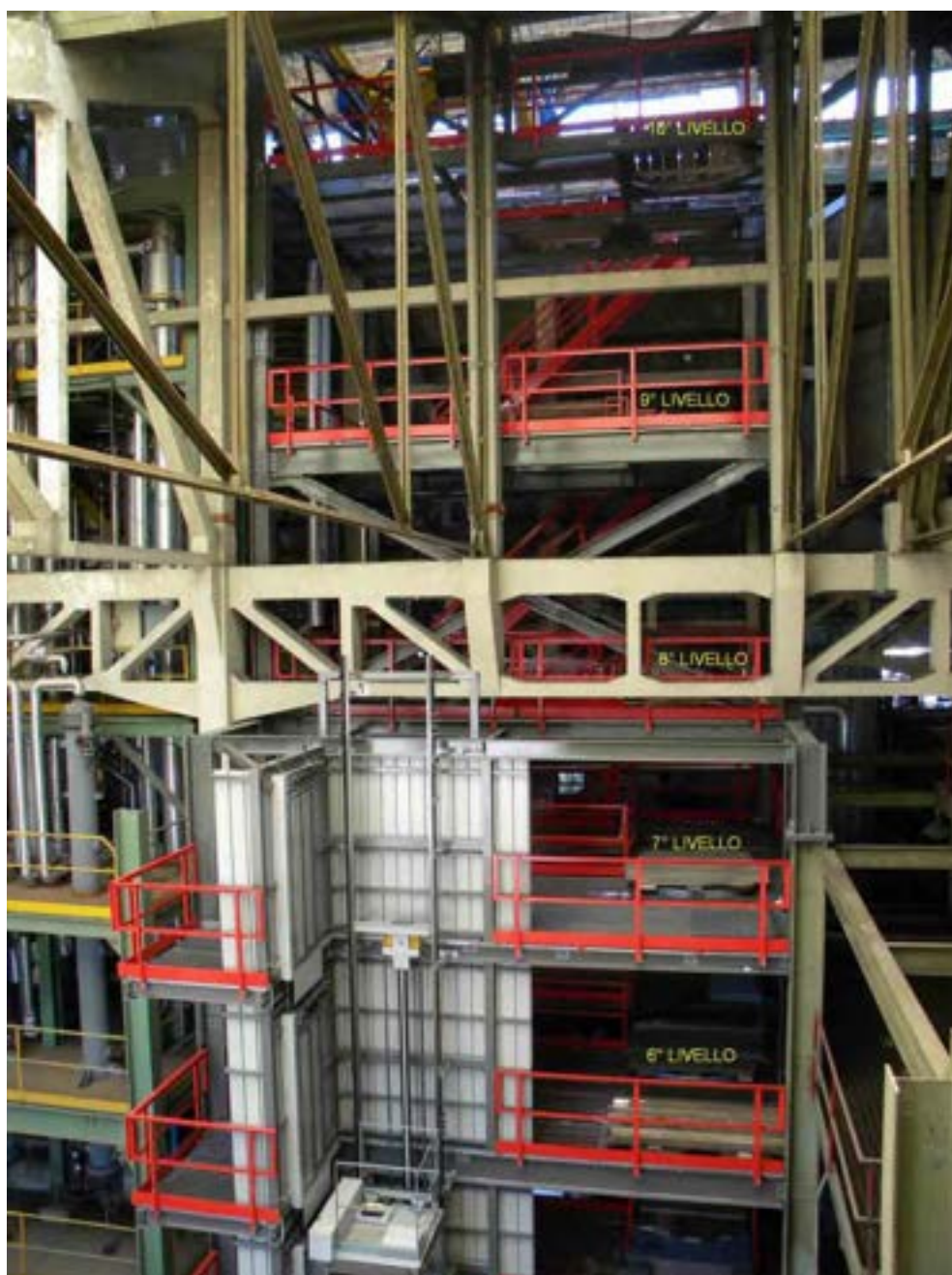
Foto2: Struttura metallica SPES-3, parte alta (livelli da 6° a 10°)
