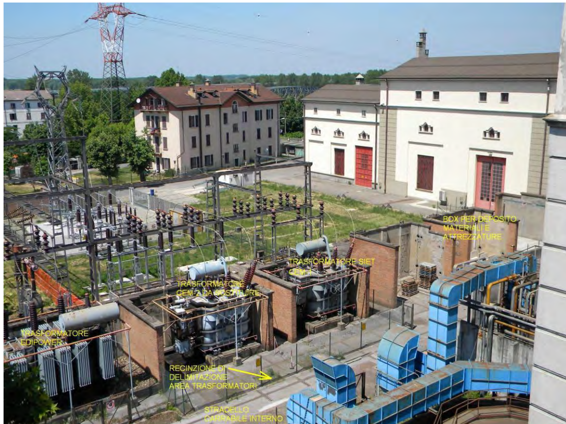
Foto3: Area esterna con ubicazione trasformatori e relativa rete di delimitazione
