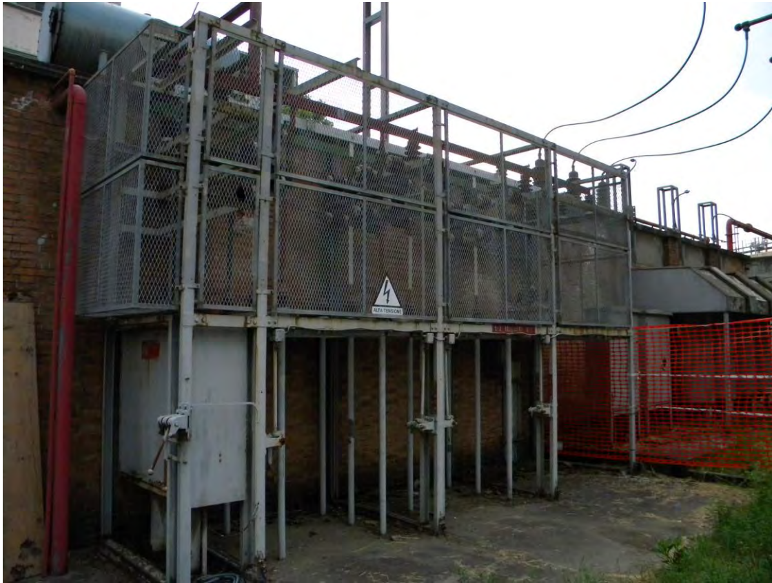
Foto2: Castello interruttori, da rimuovere, posto sul retro del trasformatore CEM-2
