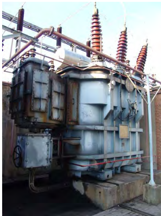
Figure 2 - Trasformatore TR2 130 / 3 kV
