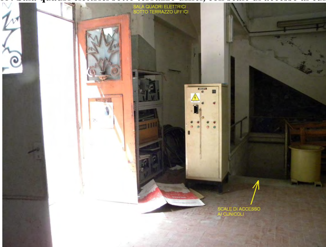
Foto5: Sala quadri elettrici sotto terrazzo uffici, con scale di accesso ai cunicoli
