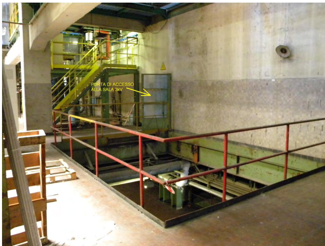
Foto6: Buca al I° piano di Centrale (piano governo), con porta di accesso alla sala 3kV
