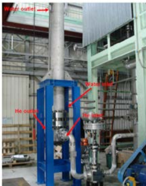
Fig. 5 – Immagine dello scambiatore elio/acqua.
