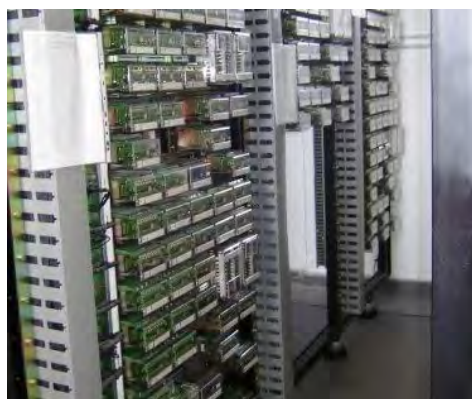
Fig. 8: Sistema di controllo a banchi di relé
