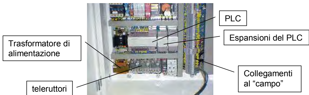
Fig.9: quadro elettrico con PLC
