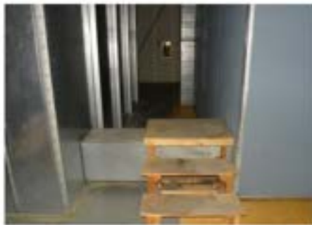
Figura 3 – Manicotto di collegamento con la camera semianecoica
