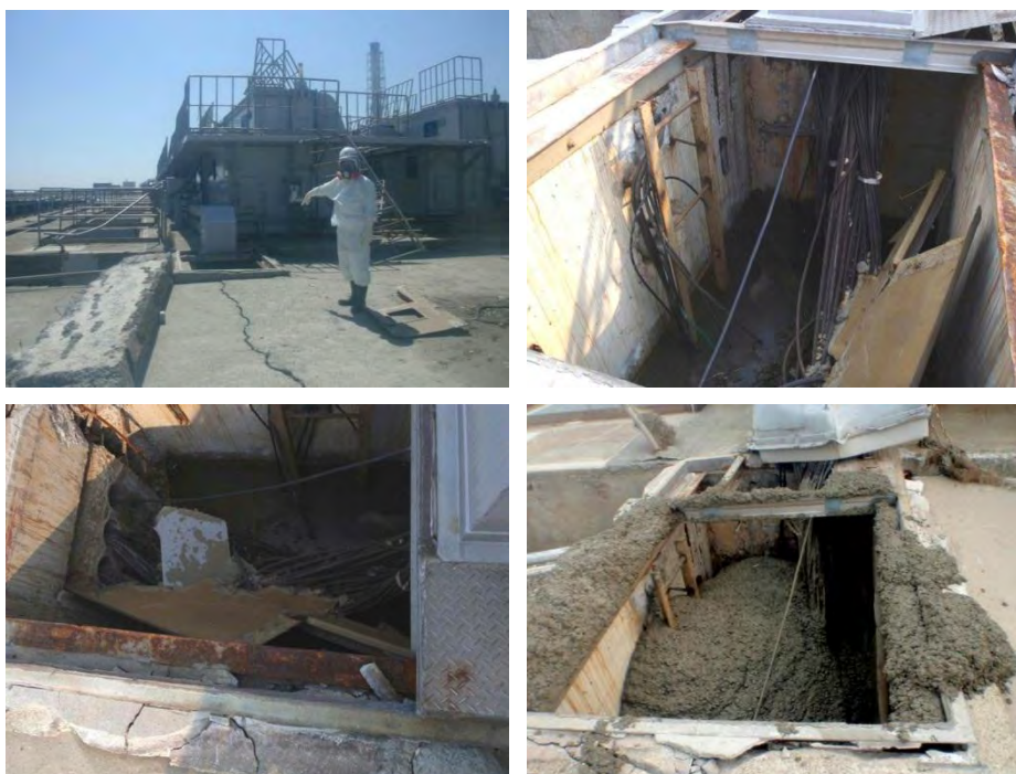
Figura 57. Immagini e dettagli del pozzetto da cui è stata individuata una perdita di acqua contaminata.
