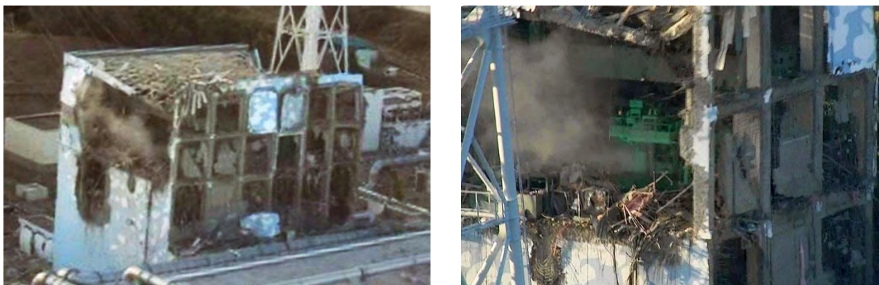
Figura 50. Stato dell'edificio reattore dell'unità 4 dopo l'esplosione di Idrogeno dalla piscina di stoccaggio.
