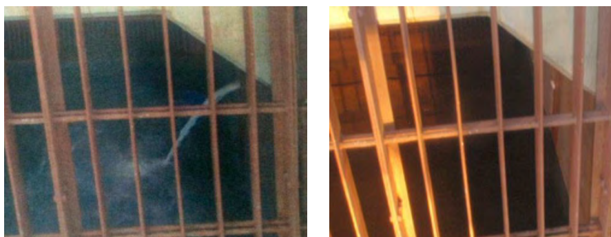
Figura 58. Stato della perdita prima e dopo l'iniezione del coagulante.
