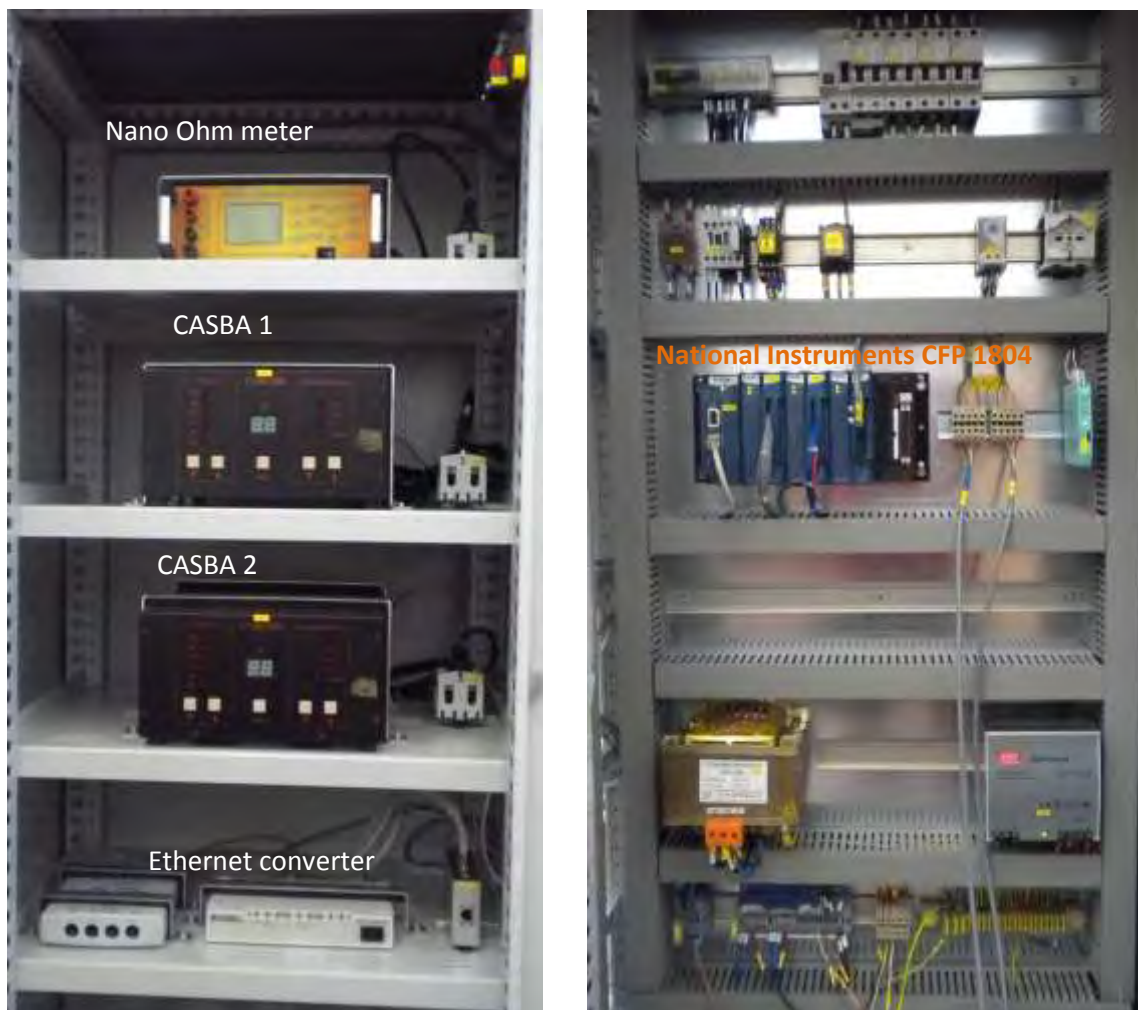
Fig 6 – Componenti elettriche ed elettroniche del sistema di monitoraggio.
