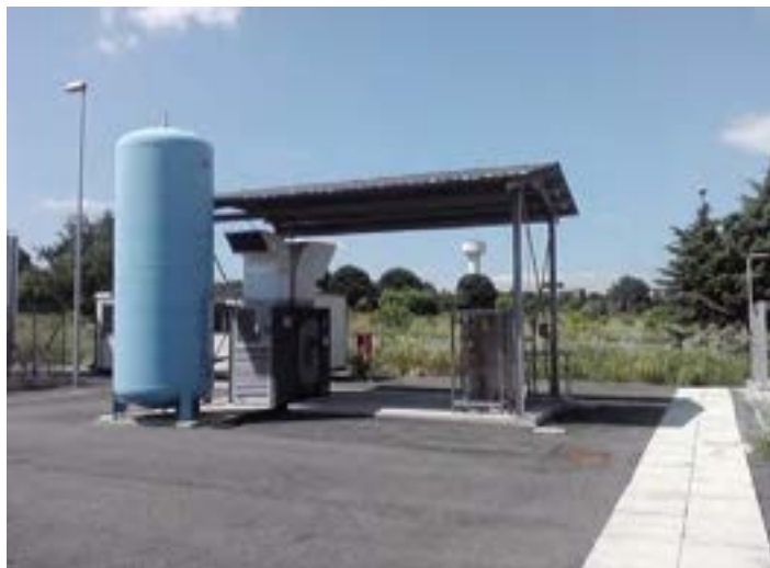
Figura 3 Piazzola di produzione aria compressa
