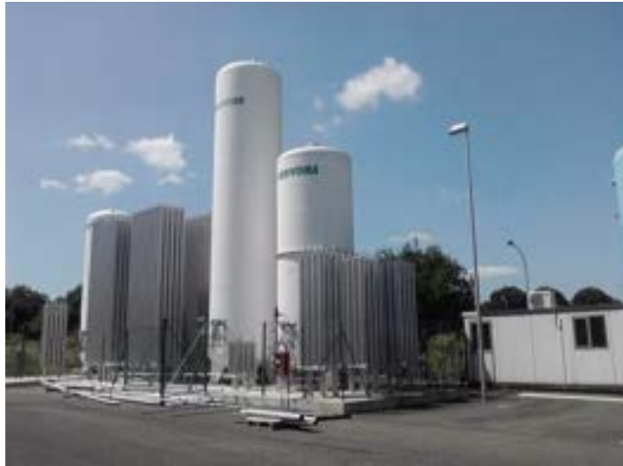
Figura 1 Piazzola di stoccaggio serbatoi criogenici (azoto-ossigeno, anidride carbonica)
