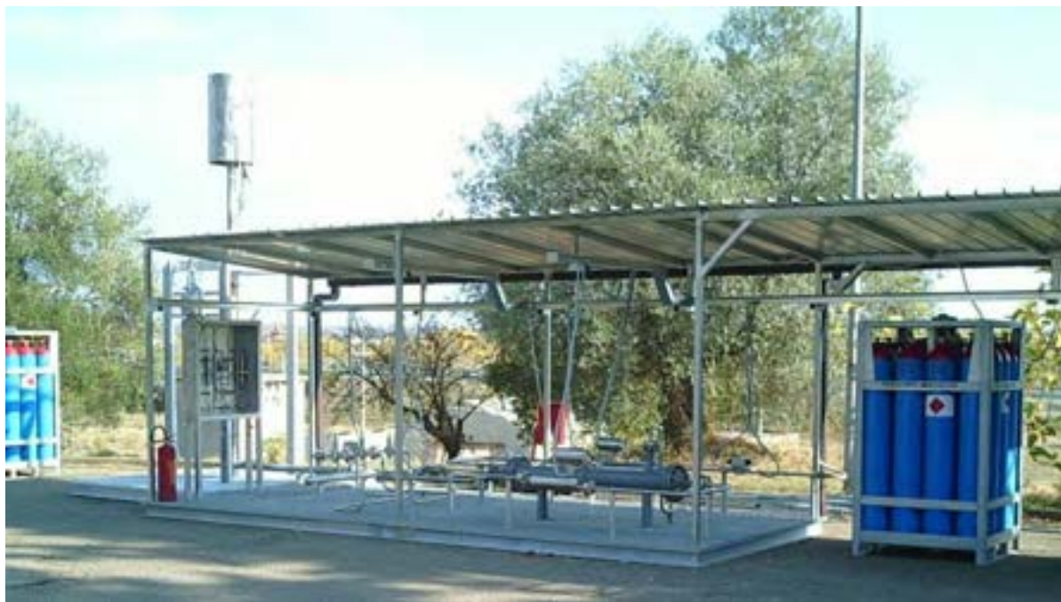
Figura 1 - Impianto di Upgrading del biogas presente nel CR ENEA Trisaia
