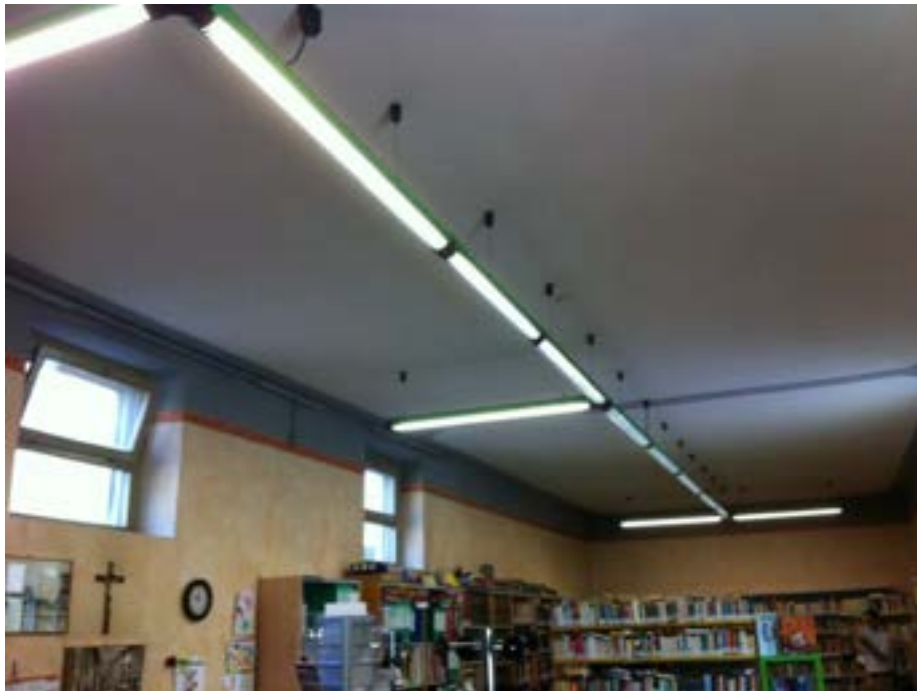
Figura 35 Disposizione degli apparecchi all'interno dell'ambiente
