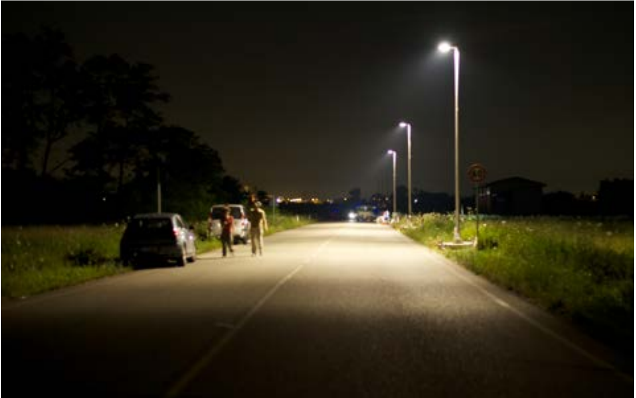
Figura 49 Impianto con apparecchio con vetro curvo e con lampada a ioduri metallici.
