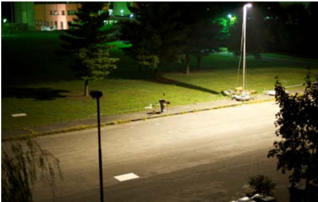
Figura 66 Impianto con apparecchio con vetro curvo e con lampada a ioduri metallici – terzo esempio di acquisizione dall’alto – immagine fotografica.
