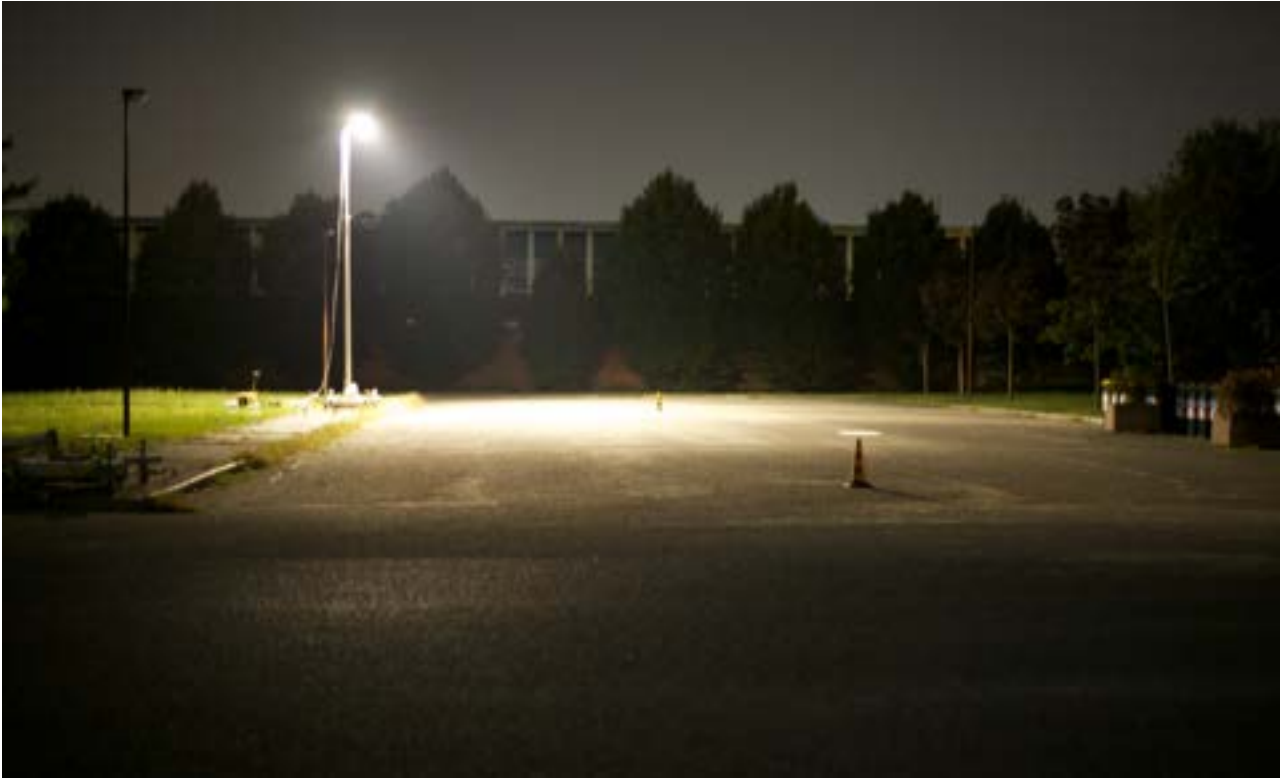
Figura 56 Impianto con apparecchio con vetro curvo e con lampada a ioduri metallici.
