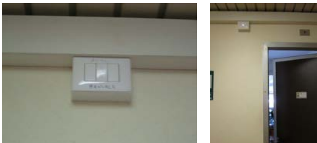
Figura 21: Interruttore manuale di esclusione sensore posizionato all’esterno degli uffici.
