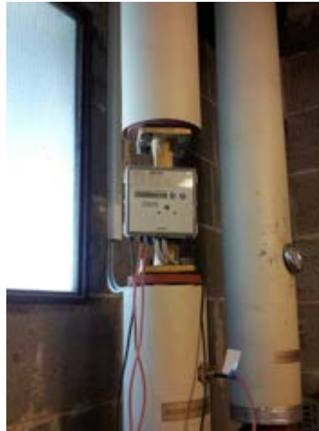
Figura 16: Contabilizzatore di calore installato sul tubo di mandata del circuito dei fancoils.
