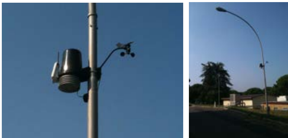
Figura 11: Simple life METEO1, centralina microclimatica installata all’esterno dell’edificio.
