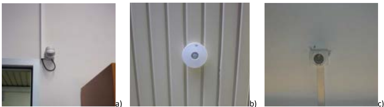
Figura 10: Rilevatori di presenza installati nell’edificio F40: a) VEMER 200, sensore installato negli uffici; b) VEMER 200, sensore installato nei corridoi e nei bagni; c) Altenburger MSD, sensore installato nella control room.
