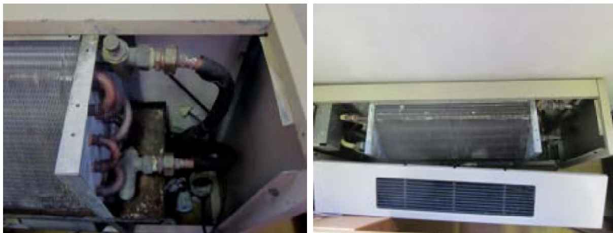
Figura 6: Terminali fancoils a 4 tubi installati negli uffici
