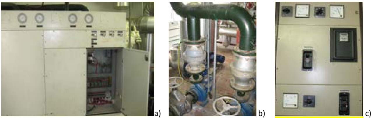
Figura 28: a) Gruppo frigorifero, b) elettropompe di circolazione e c) quadro elettrico in centrale termica
