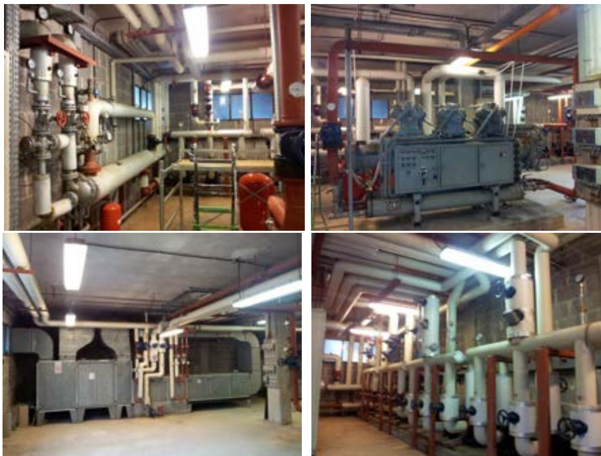
Figura 4: Immagini della centrale Termica dell'edificio F40. Nello specifico: a) scambiatore di calore; b) gruppo frigorifero; c) unità di trattamento aria; d) elettropompe
