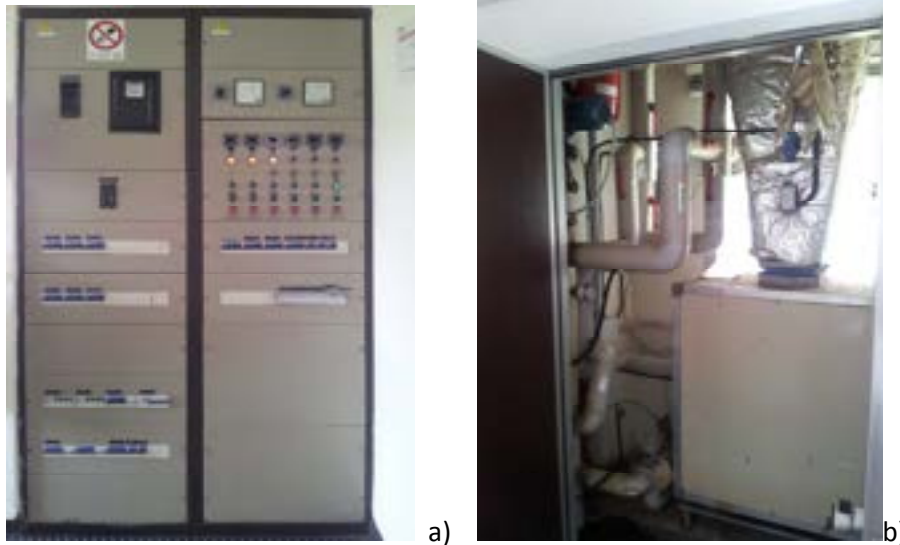
Figura 30: a) quadro elettrico e b) sottocentrale di edificio.
