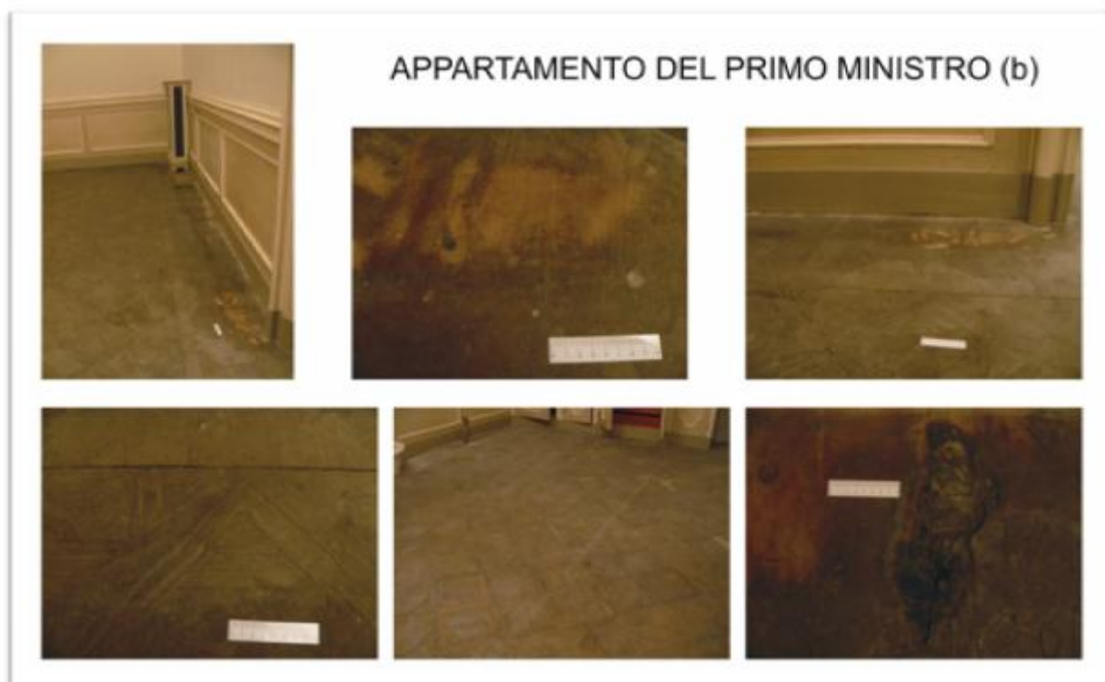
Fig. 2. Documentazione fotografica delle principali forme di degrado rilevate nelle sale pertinenti all'appartamento del primo ministro. (a) Stanza con camino; (b) seconda stanza e bagno.
