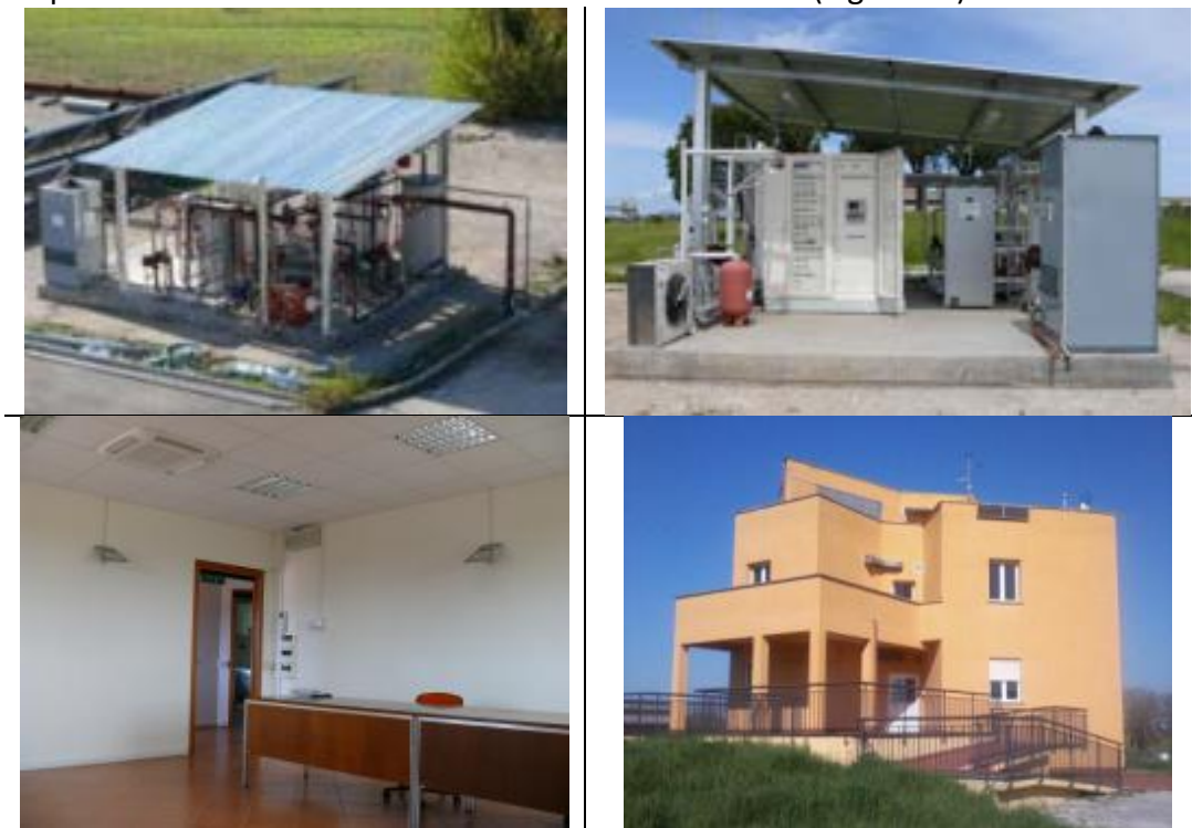
FIGURA 15: Viste dell'impianto e dell'edificio F-92
