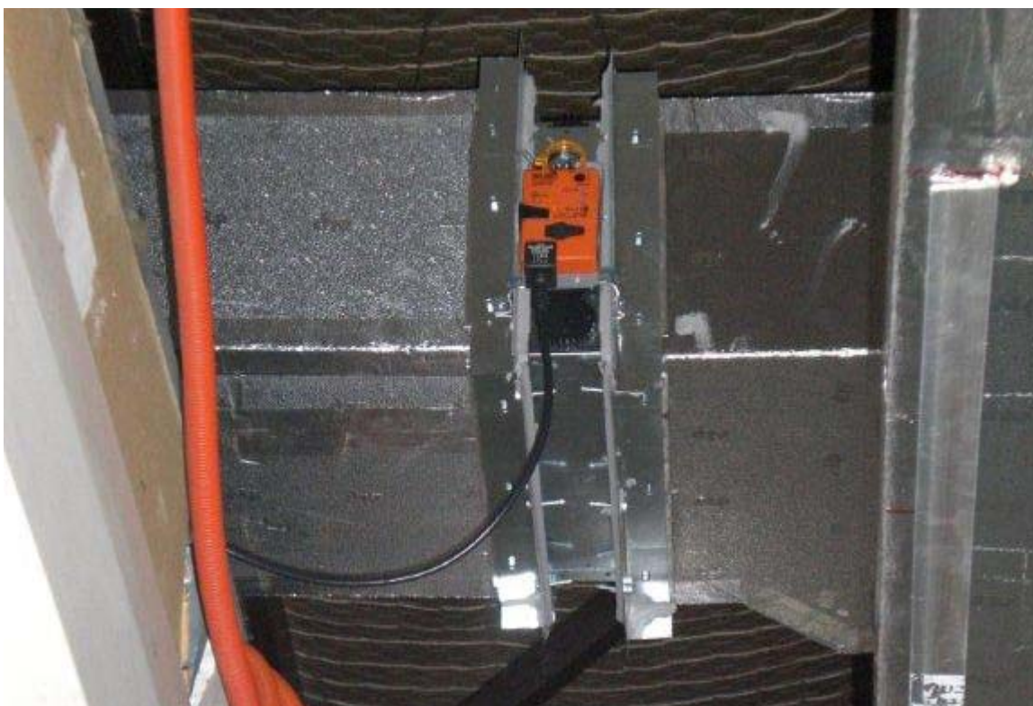
Figura 30. Serrande di regolazione servocomandate per la gestione della portata d'aria immessa nei vari ambienti
