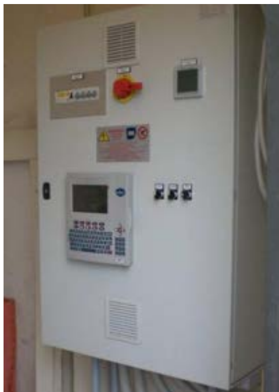
Figura 31. Quadro elettrico di potenza e controllo
