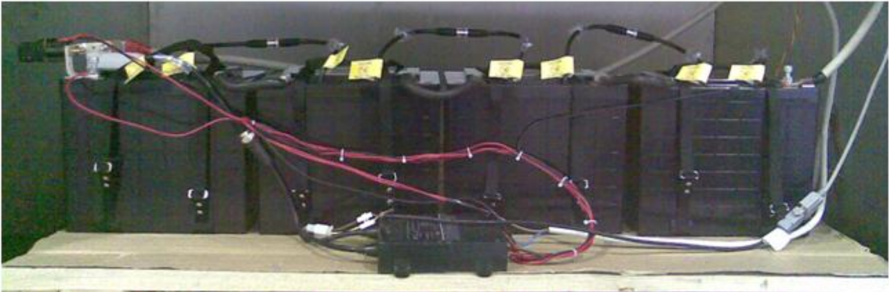
Figura 36 - Sistema batterie 48V – 100 Ah
