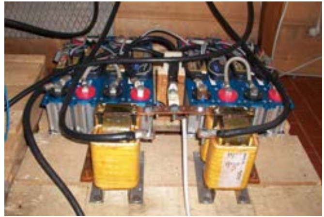
Fig. 6.2.2) Supercondensatori MAXWELL 16V 250F n. 4x2 moduli - 48V DC 125F Induttanze funzionali al convertitore DC-DC
