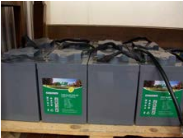
Fig. 6.2.1) Batterie HAZE 6V 200Ah n. 8 moduli 48 VDC.
