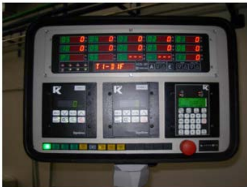
Fig. 7 Pannello di controllo dell'estrusore
