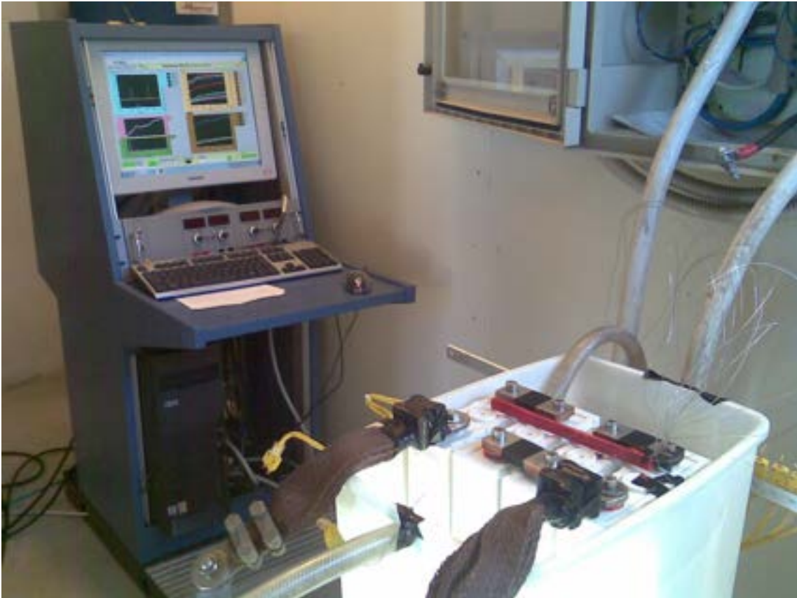
Fig. 23 – Impianto per prova di raffreddamento con acqua
