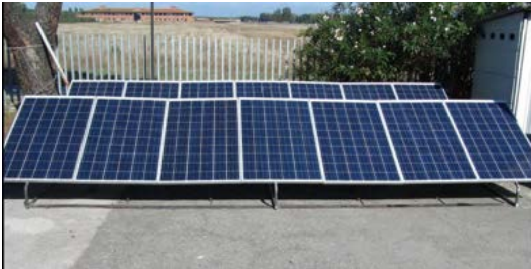
Figura 3. I pannelli fotovoltaici collegati a formare due stringhe
