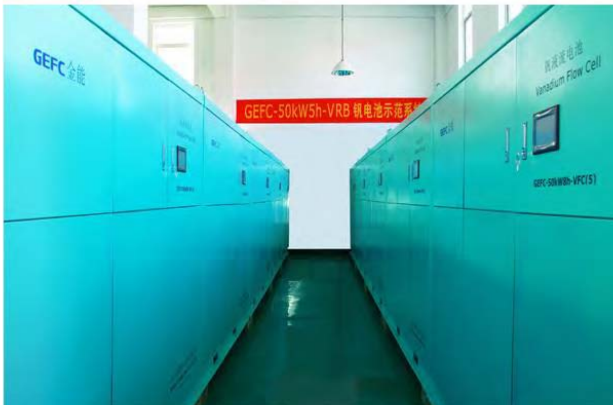
Figura 8. Sistema GEFC da 50 kW/250 kWh
