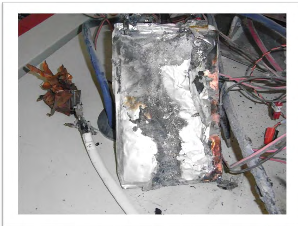
Figura 17. Danni subiti dalle celle: in primo piano la cella n. 4, in secondo piano, residui delle altre celle.
