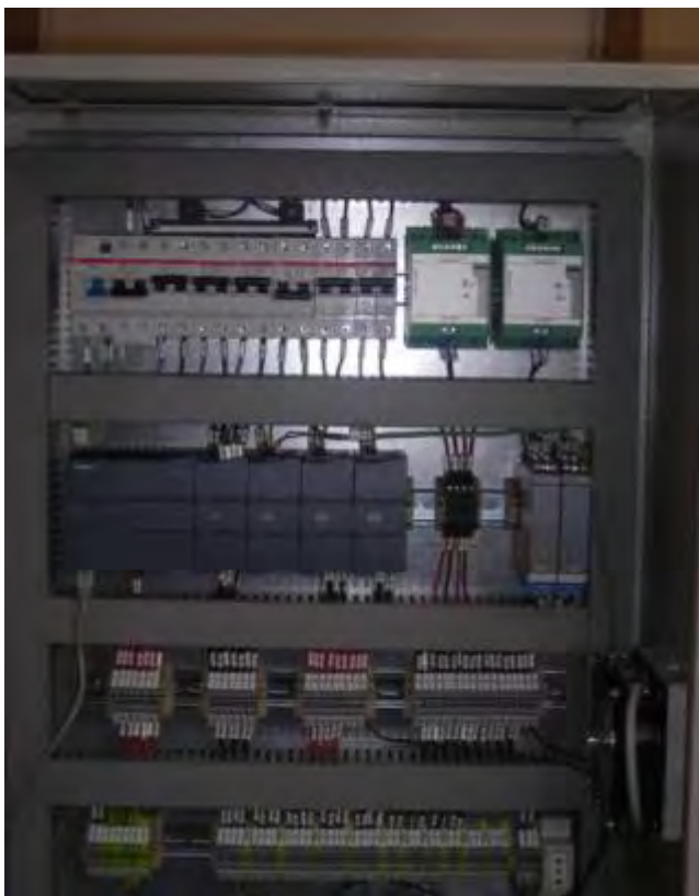
Figura 30. Quadro di Controllo
