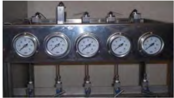
Figura 26. Manometro gas inlet
