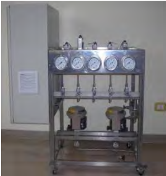
Figura 25. Stazione di controllo BIOSNG
