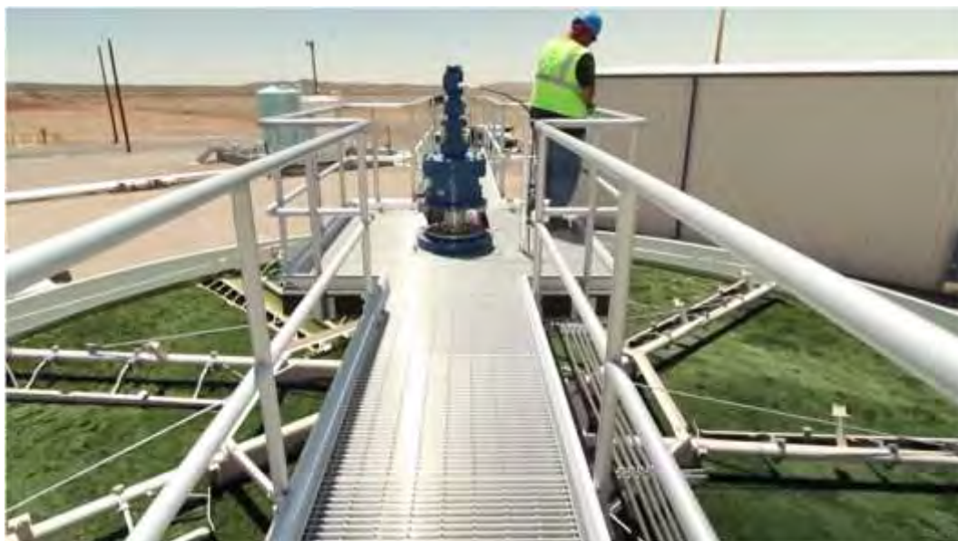
Figura 11. Particolare dell'impianto della Sapphire Energy
