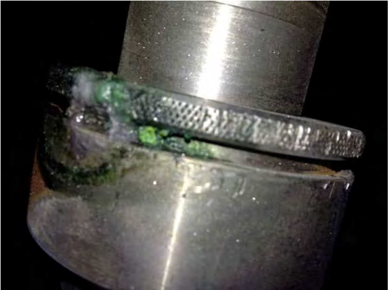
Figura 13 Evidenza di fuoriuscita di fluido sul trasduttore di pressione TP2
