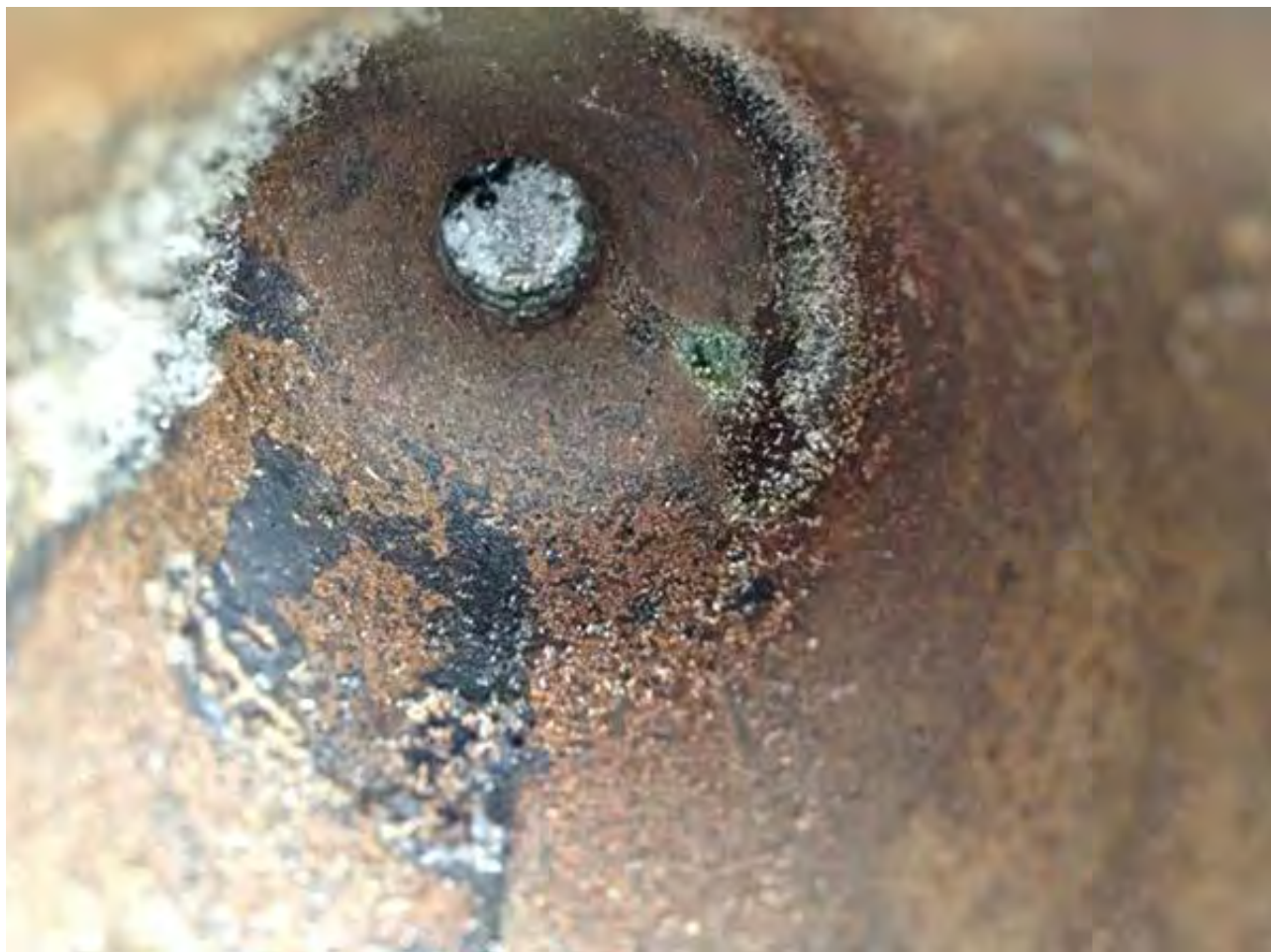
Figura 14 Particolare della superficie interna del cilindro dopo il taglio
