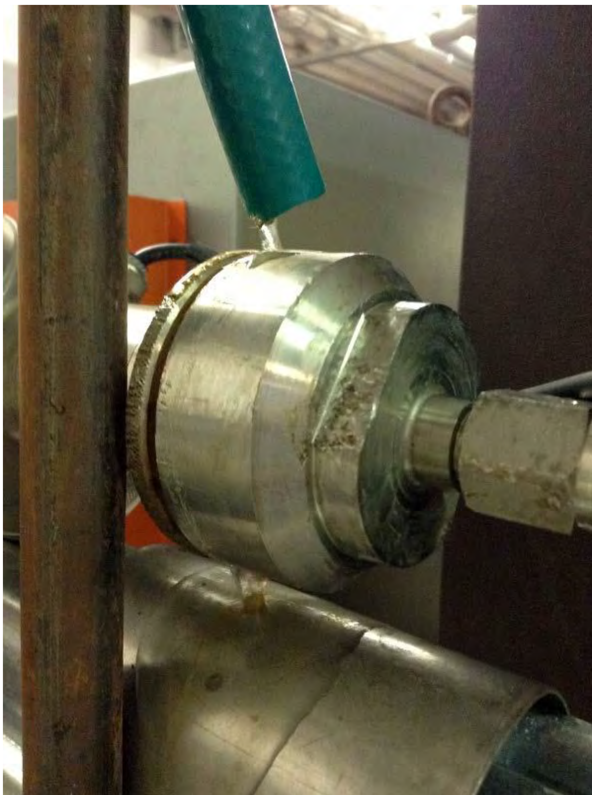
Figura 15 Il sistema allestito per il raffreddamento della sezione di connessione al circuito del trasmettore di pressione TP2
