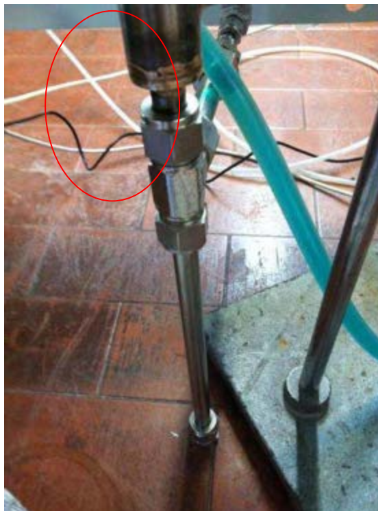
Figura 22. Raccogliatore di condensa connesso al condensatore con una tee-union (cerchiata in rosso)
