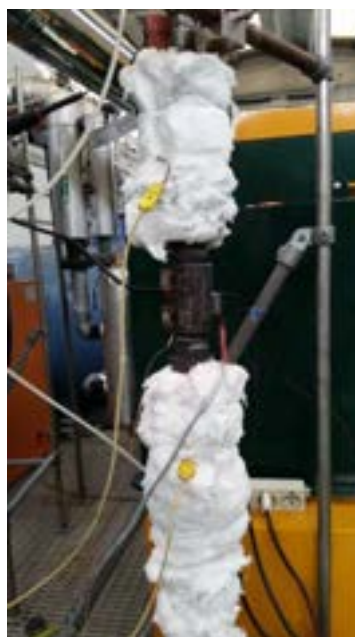
Figura 2. Particolare della linea di campionamento fumi, con il riscaldatore elettrico a fascia ceramica e la coibentazione in lana minerale per alte temperature a monte e a valle del riscaldatore
