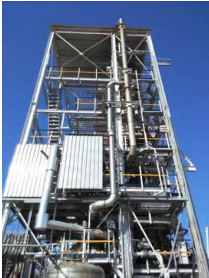
Figura 2.24. Linea di vent aggiuntiva (al centro)
