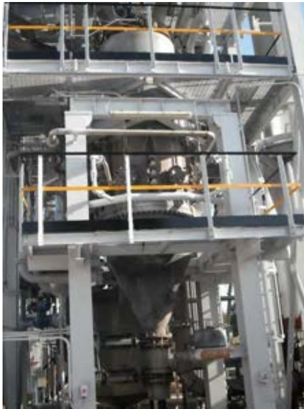
Figura 1.2. Vista frontale de gassificatore dell'impianto dimostrativo
