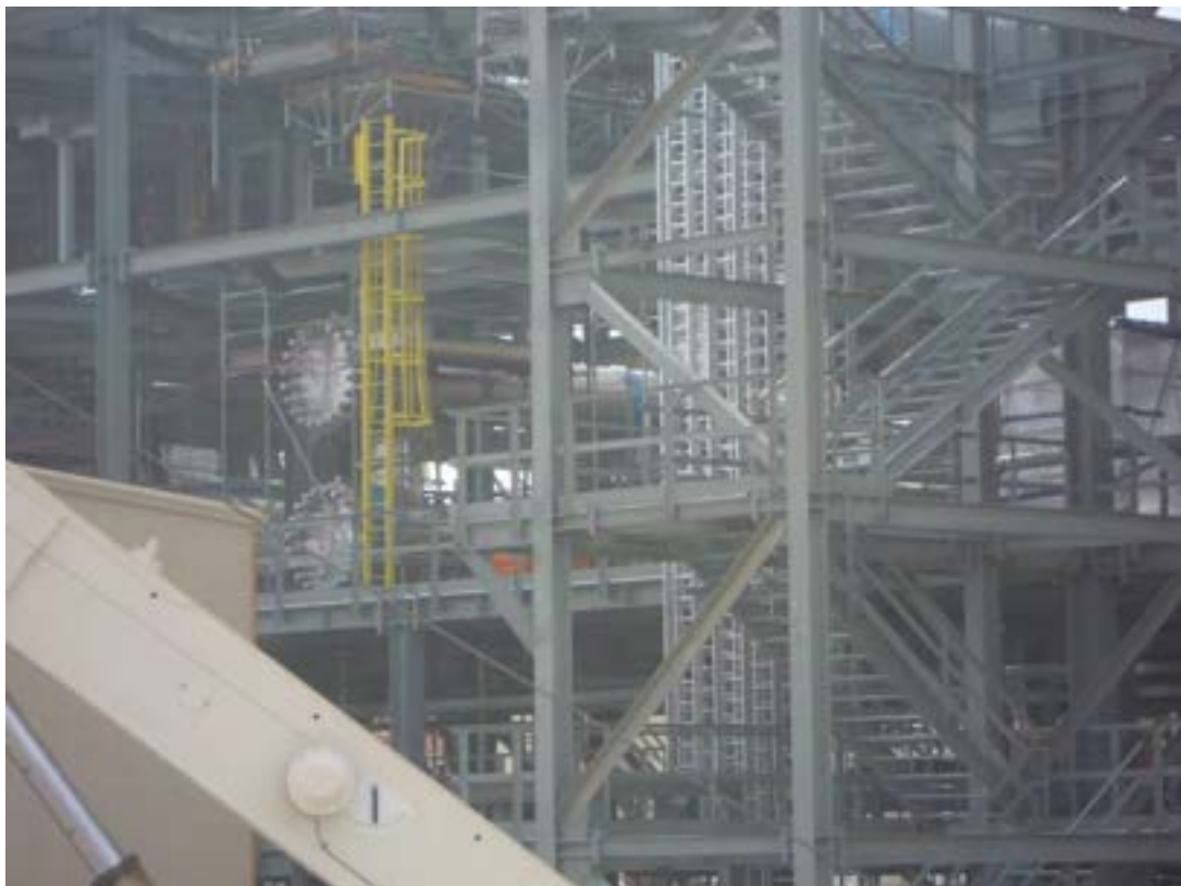
Figura 10: Particolare del generatore di Vapore
