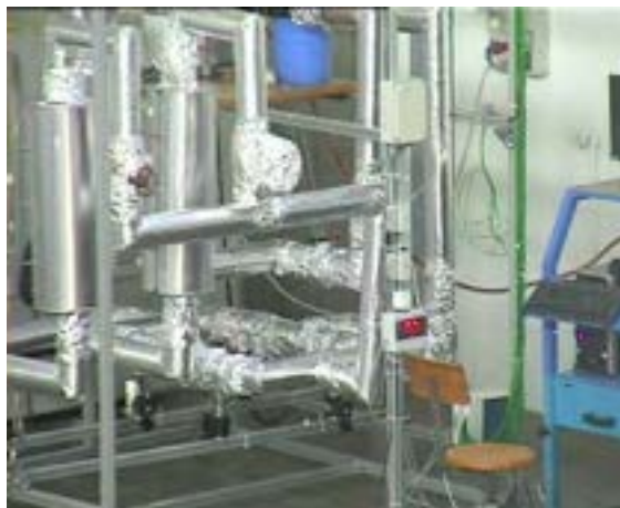
Figura 1- Scorcio dell'impianto ATES in Enea Casaccia (Roma)
