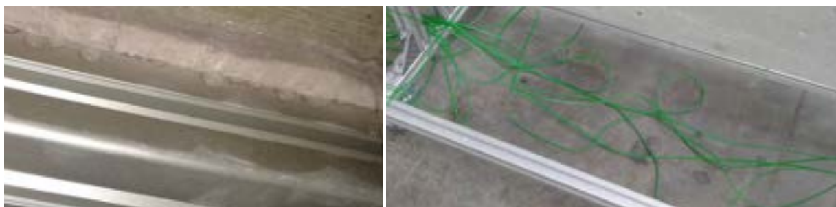
Figura 40: Condensazione e gocciolamento del modulo UNITN-CESTARO.
