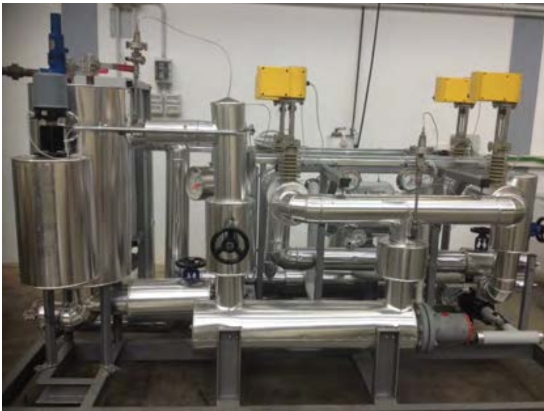
Figura 11: vista della sezione di riscaldamento dell'impianto Solteca3.
