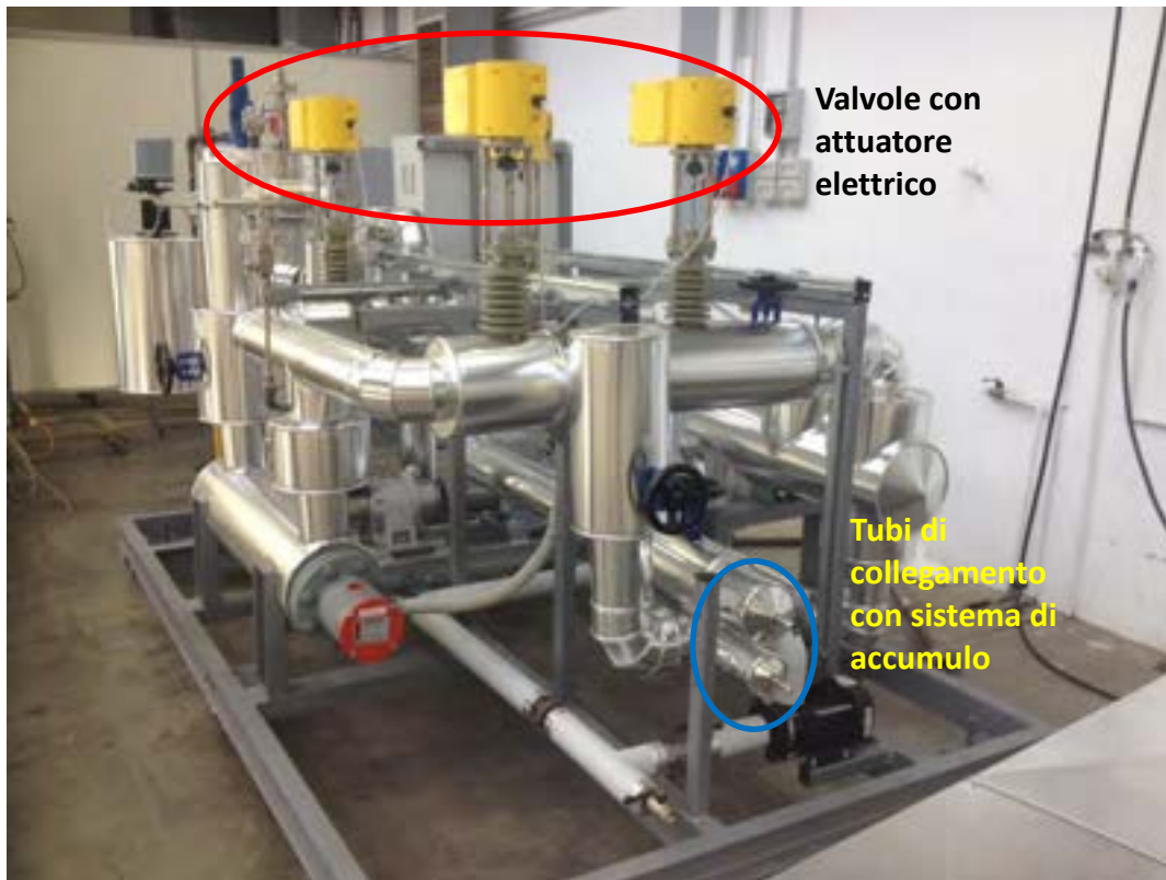
Figura 9: particolare dell'impianto Solteca3, nel quale sono visibili le valvole con attuatore elettrico e i tubi di collegamento con il sistema di accumulo.
