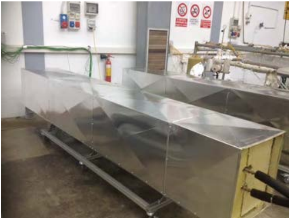
Figura 18: particolare del sistema di accumulo con coibente e lamierino.
