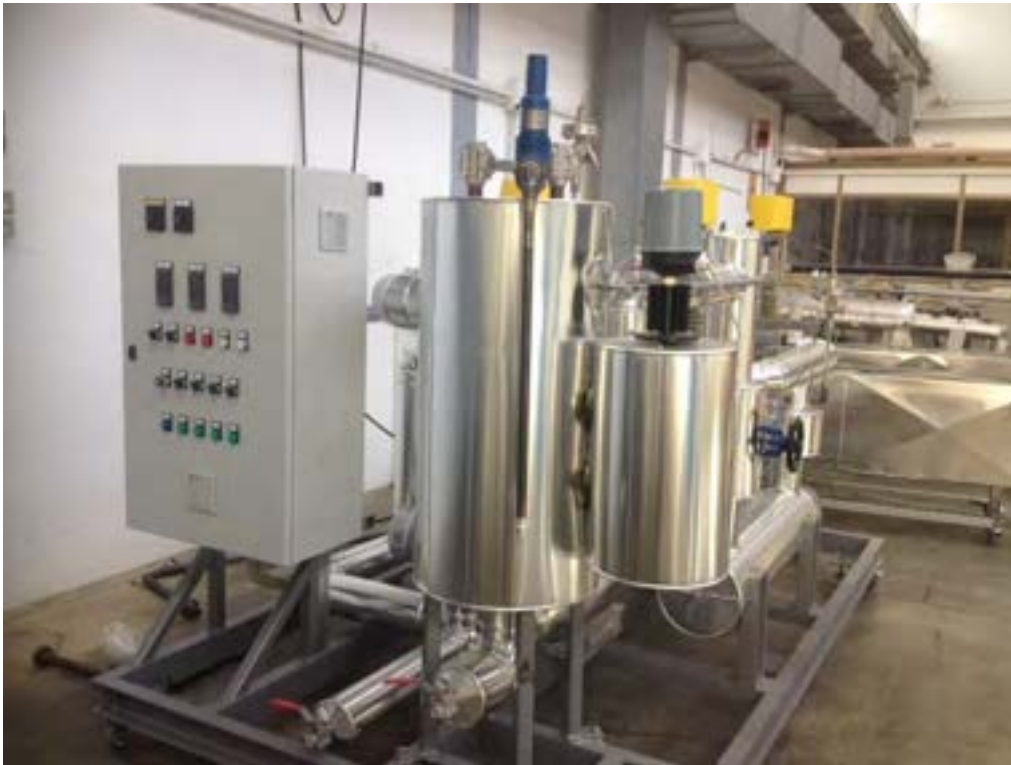
Figura 7: particolare dell'impianto Solteca3, nel quale è possibile vedere il quadro di comando in locale.
