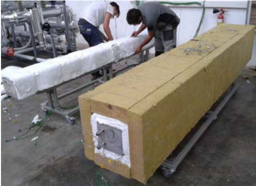
Figura 17: particolare del sistema di accumulo, nel quale si vedono gli strati di coibentazione.
