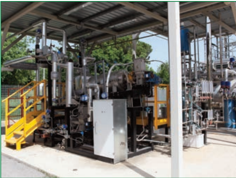
Impianto VALCHIRIA; lato raffreddamento fumi
