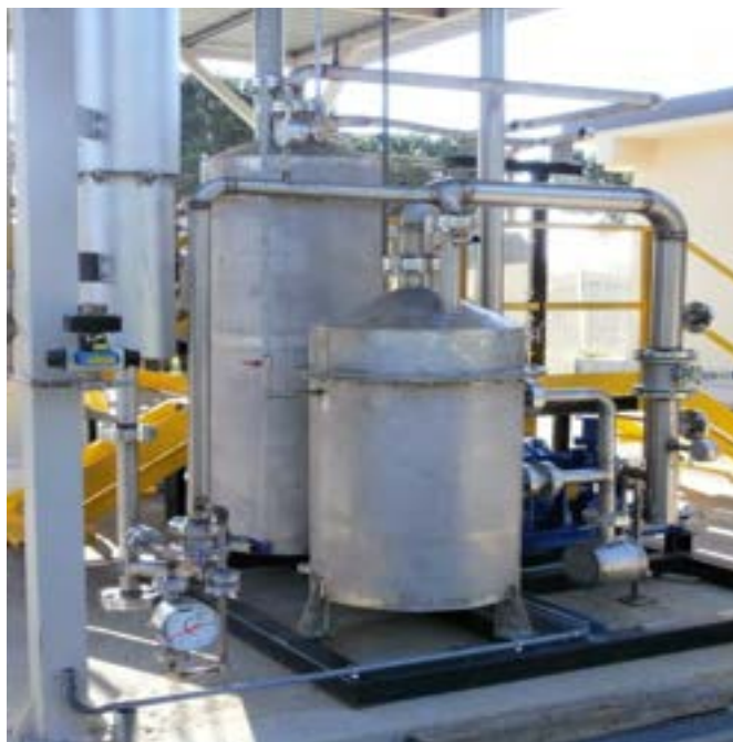
Figura 4 - Sistema di raffreddamento montato su skid.
