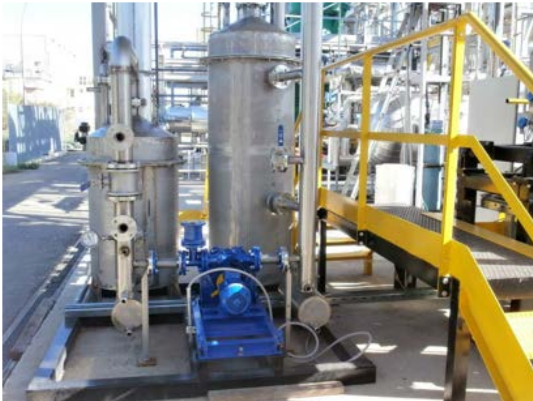
Figura 6 – Soffiante e sistema di raffreddamento – alloggiamento su skid
