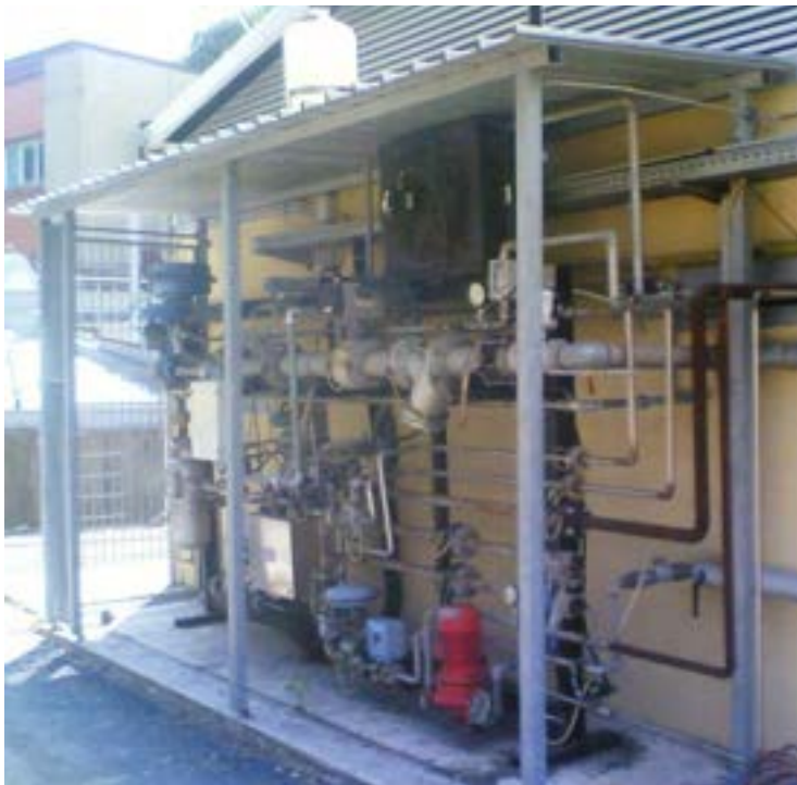
Figura 4. Skid di controllo e regolazione dell'aria comburente e del gas naturale.
