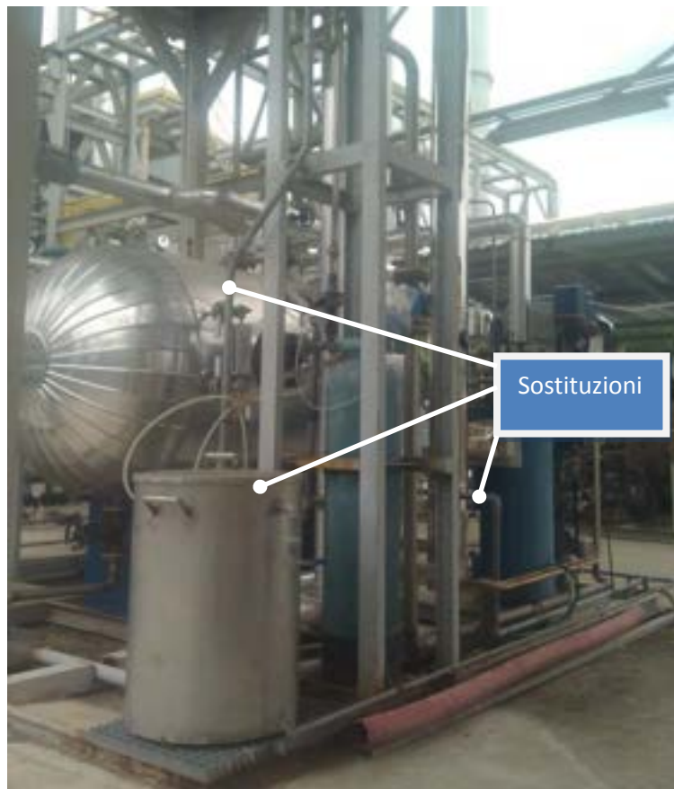
Figura 10 Interventi migliorativi sull'impianto di produzione di acqua demineralizzata
