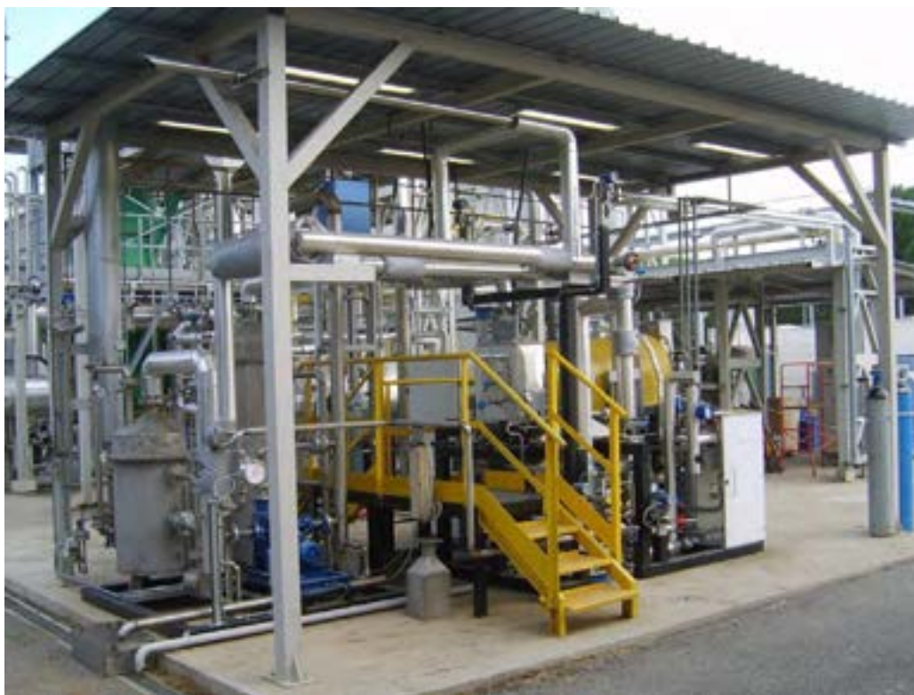
Figura 1 - Impianto VALCHIRIA; lato raffreddamento fumi.
