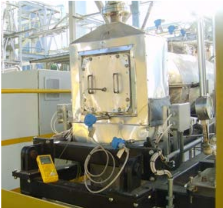
Figura 6 - VALCHIRIA - Pirolizzatore lato camera di calma; misure di temperatura.
