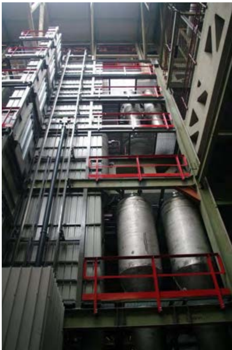
Figura 8 – Serbatoi del contenimento SPES-3 installati sulla struttura
