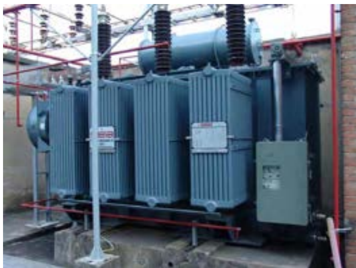
Figura 7 – Nuovo trasformatore 130.000 / 3.000 V
