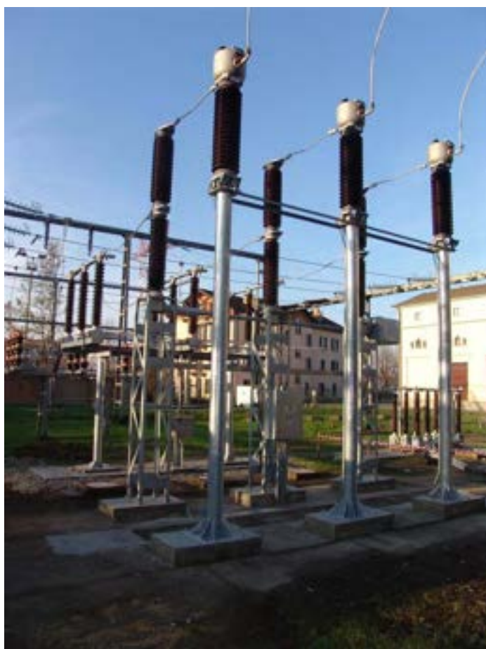
Figura 6 – Nuovo interruttore stazione 130.000 V
